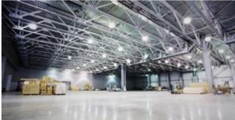
Figura 13. Iluminación con sensores leds
