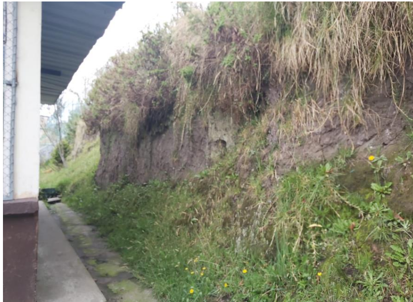
Ilustración 14. Taludes con peligro de movimientos en masa
