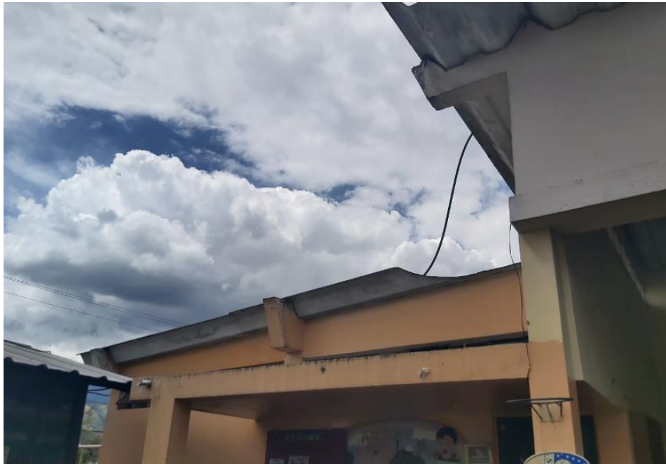
Ilustración 16. Techos en mal estado
