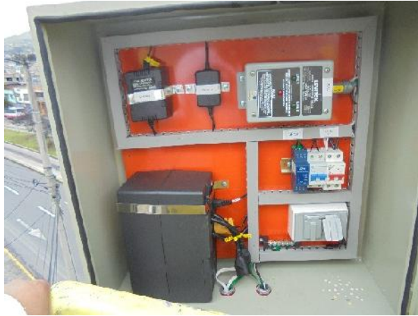
Imagen No. 21 Caja eléctrica para pórticos - Autoría Propia
