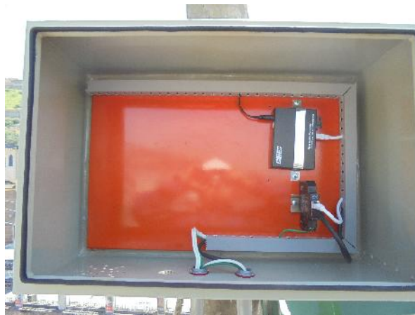
Imagen No. 20 Caja electrónica para pórticos - Autoría Propia
