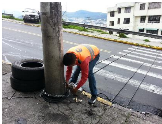
Imagen No. 2 Instalación de Contador Vehicular de Manguera o Tubo - Autoría propia
