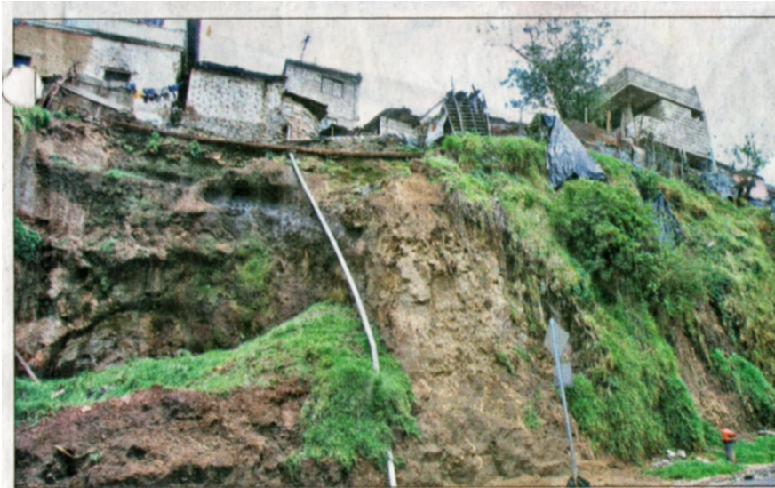
En La Libertad. El terreno de los taludes está húmedo por las lluvias recientes. Los plásticos que fueron colocados para cubrirlo están inservibles.
