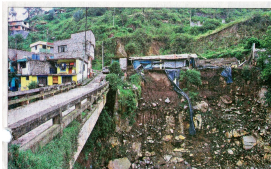
En San Francisco de Miravalle. La casa de Luis Caluquí está por desplomarse hacia el río Machángara. Los plásticos que cubrían el talud están rotos y viejos.
