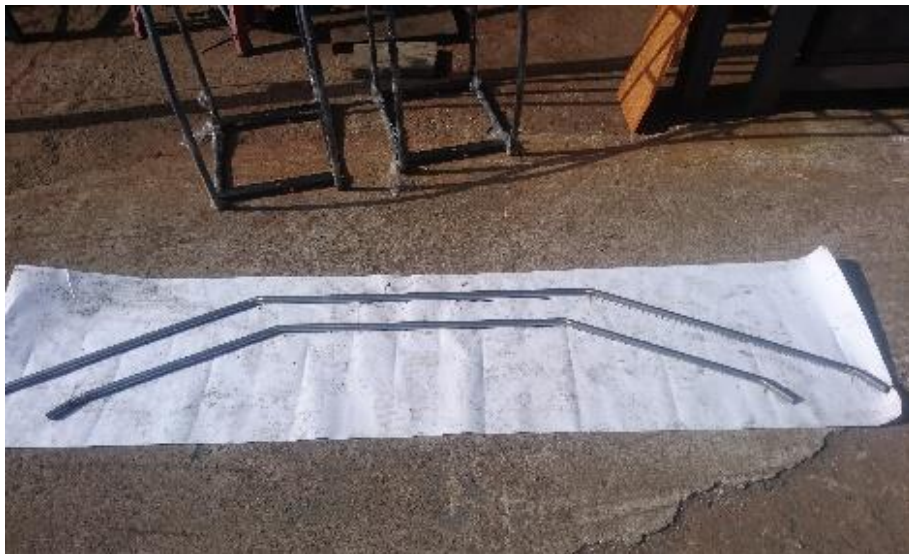
Figura 67. Matrices para corte y doblado de cruces o conectores. Fuente elaboración propia.
