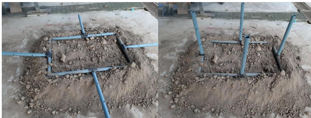
Figura 4. Sistema de aireación por tuberías de Policloruro de Vinilo (PVC) para ensayos estáticos en campo.
