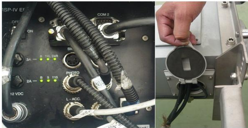
Foto 3.17 Disposición de los cables en la caja de conexión. Fuente: Ing. Víctor Lasso e Ing. Segundo González.
