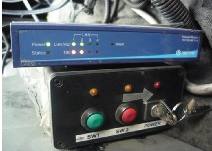
Foto: 3.6 Switch Box.
