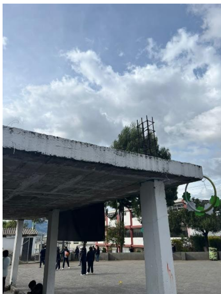
Anexo 16: falta de mantenimiento en las estructuras metálicas, con presencia de corrosión.
