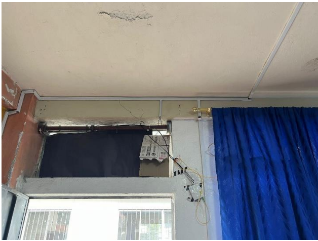
Anexo 14: estructura prefabricada con daños, y presencia de humedad.
