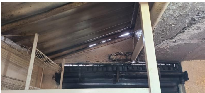
Anexo 18: bajante de aguas sanitarias por medio del bar.
