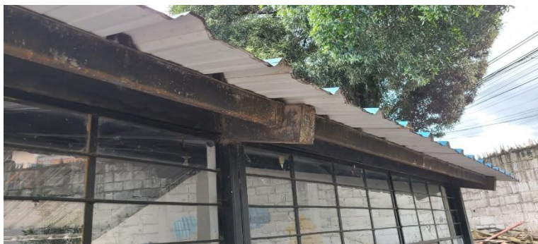
Anexo 17: losa de cubierta del bar, con presencia de fisuras y humedad.
