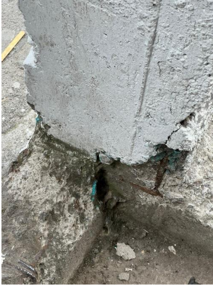
Anexo 20: estribos vistos de vigas.
