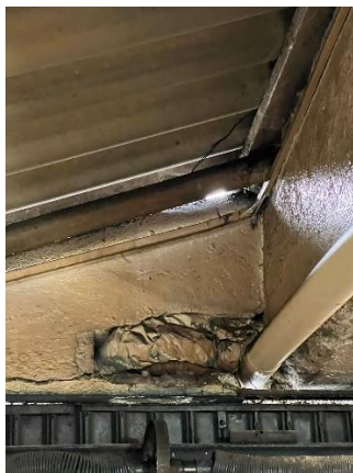
Anexo 8: corrosión en correas de estructuras metálicas.
