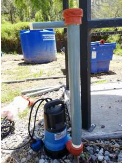
Instalación de bombas sumergibles
