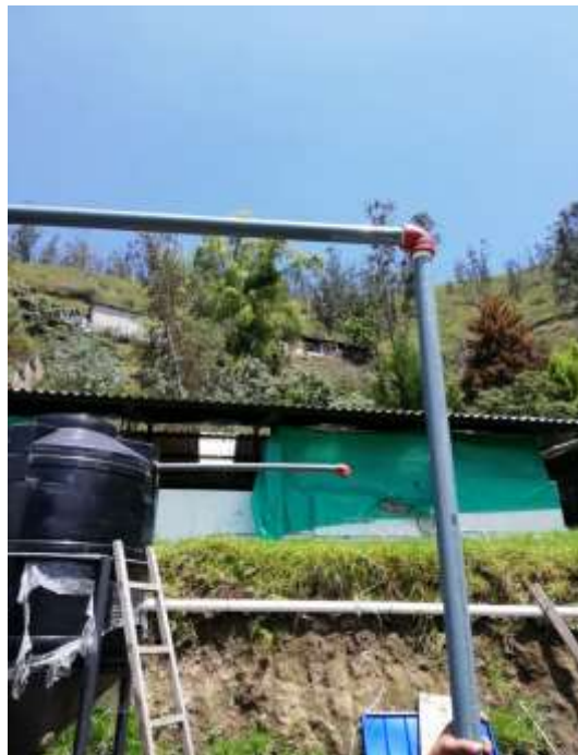
Instalaciones de tuberías en clarificadores
