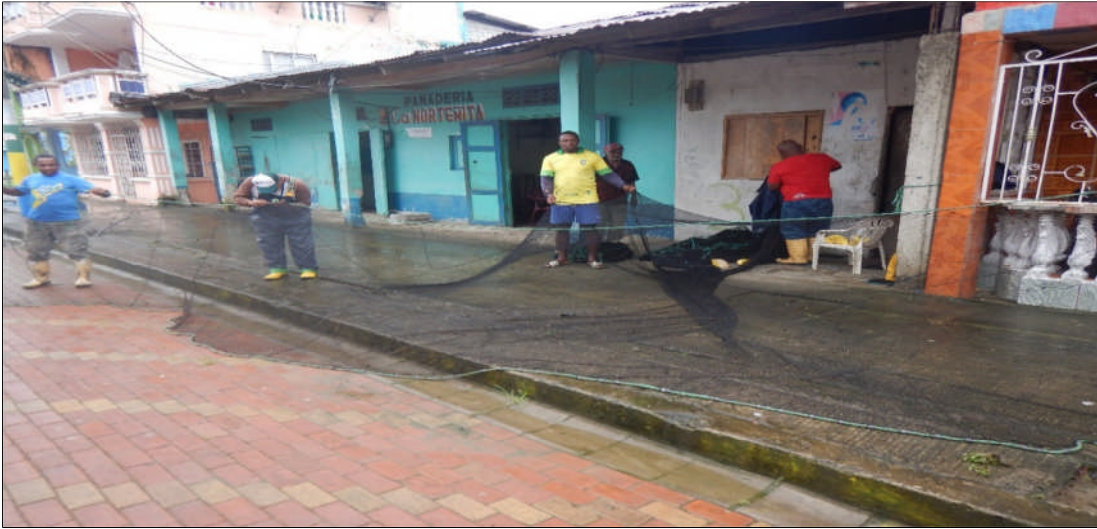
Anexo 1. Instalaciòn de los dispositivos.
