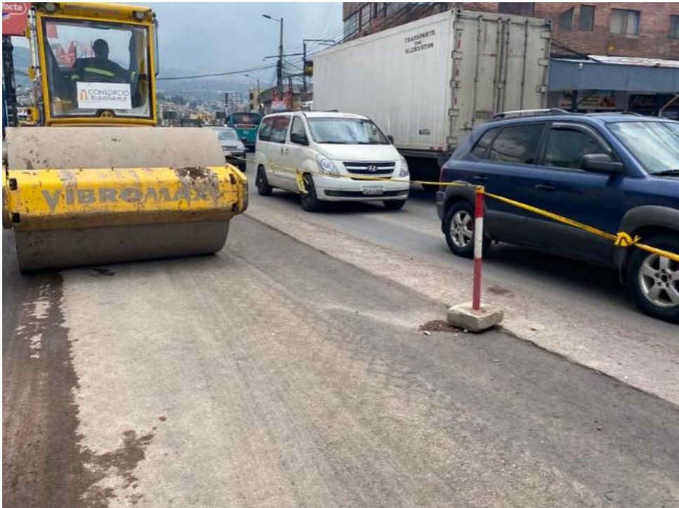
Ilustración N°2: Ausencia de jersey de hormigón divisor Autor: Nicolas Hurtado
