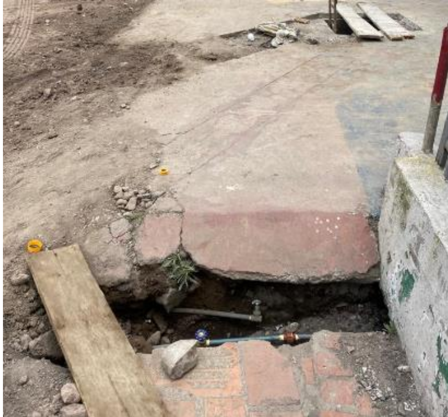
Ilustración N°3: Falta de señalización peatonal Autor: Nicolas Hurtado
