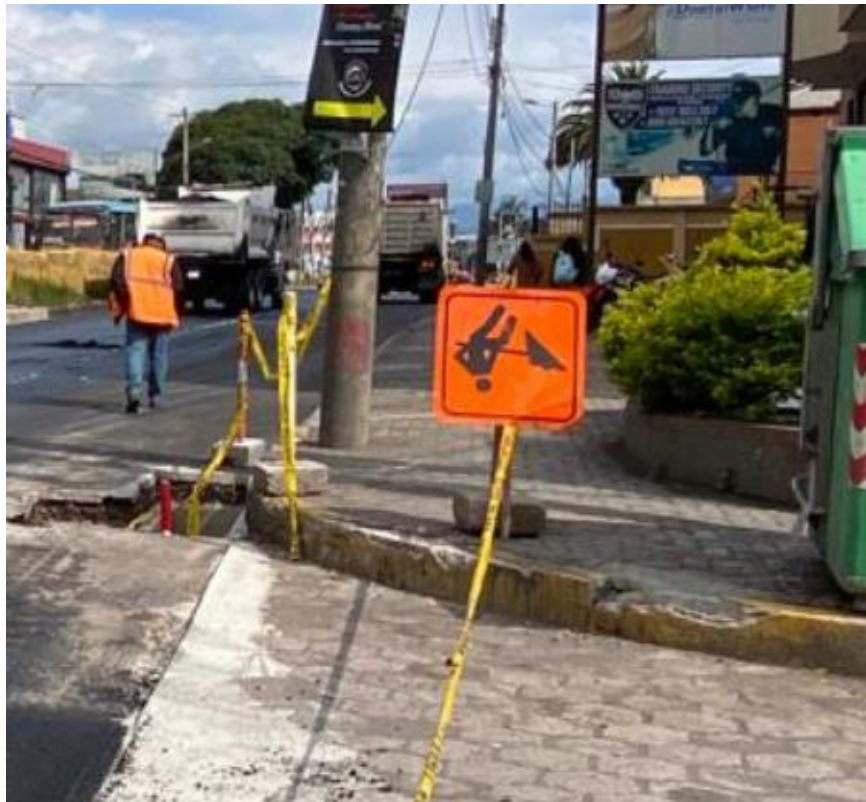
Ilustración N°10: Colocación incorrecta de señaléticas Autor: Nicolas Hurtado.
