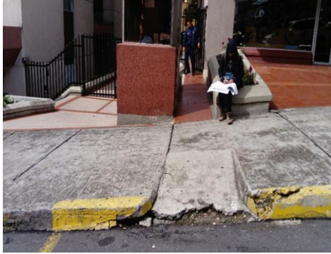
Fotografía 41. Barrera Urbana: Rampa improvisada para ingreso peatonal (Av. Gaspar de Villarroel TRAMO 2)
