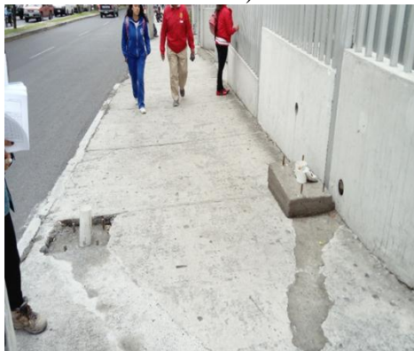
Fotografía 43. Barrera Urbana: Loseta de hormigón sobre vereda (Av. Gaspar de Villarroel TRAMO 3).
