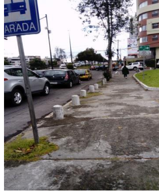
Fotografía 15. Barrera urbana: Bolardos de hormigón y aceras en mal estado (Av. Eloy Alfaro. TRAMO 1)
