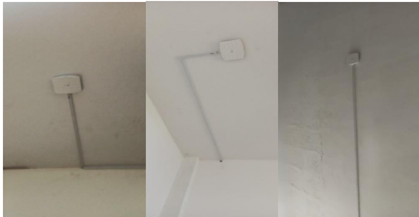
Figura 64 Puntos de accesos Eap 110 instalados
