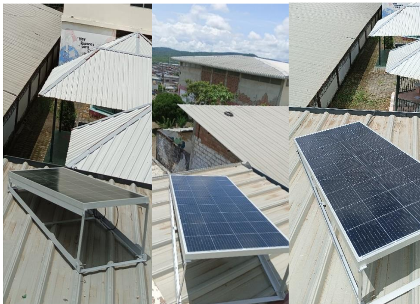
Figura 63 Instalación de soporte y panel solar Autor: Méndez Klevers
