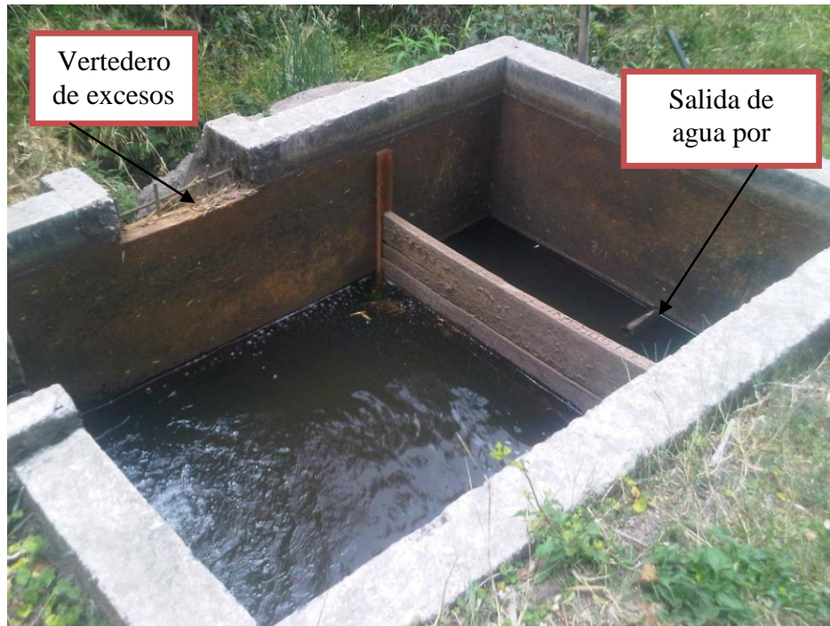
Fotografía # 6.- Tanque de Captación Hacienda San Francisco de Pasochoa.
