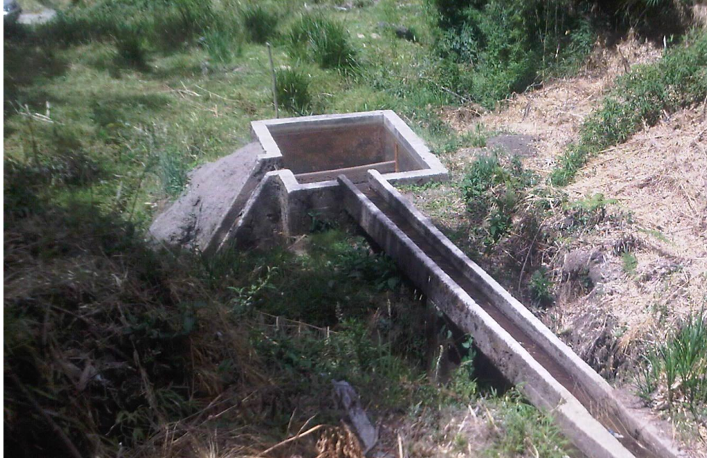
Fotografía # 5.- Canal y tanque de captación en la hacienda San Francisco de Pasochoa
