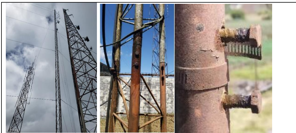
Torreta de 30 mts.
