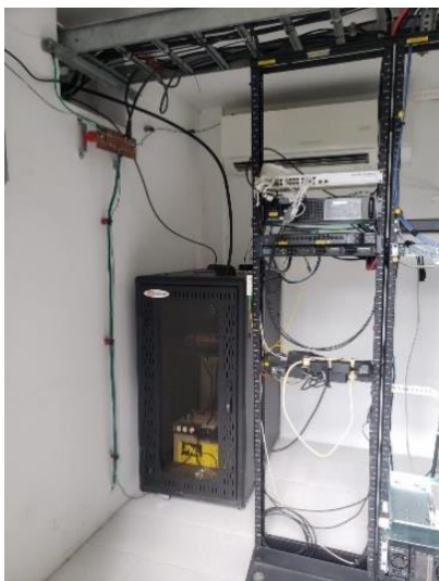
Rack equipos repetidora
