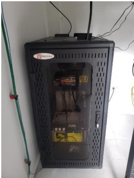
Rack equipos repetidora
