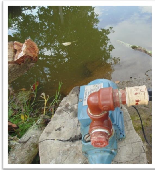
Figura 36. Sistema de bombeo
