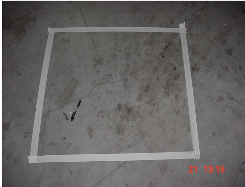
Ilustración 6.4: Identificación de fisuras en un m 2 . De parqueadero Fuente: Miguel Rivera y José Sosa
