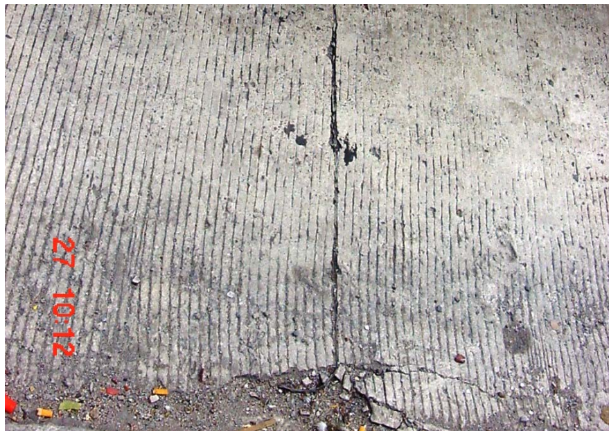
Ilustración 7.7: Daños en las juntas de los pavimentos rígidos Fuente: Miguel Rivera y José Sosa
