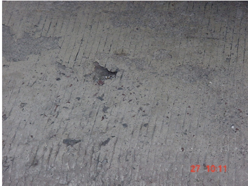
Ilustración 7.8: Desgaste normal de un pavimento rígido aparición de pequeños baches Fuente: Miguel Rivera y José Sosa
