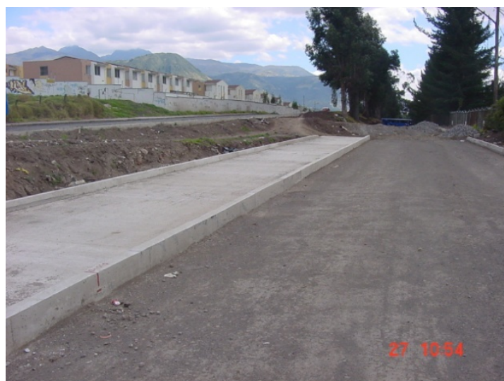
Ilustración 6.18: Construcción de un pavimento rígido, Sector Quitumbe Fuente: Miguel Rivera y José Sosa
