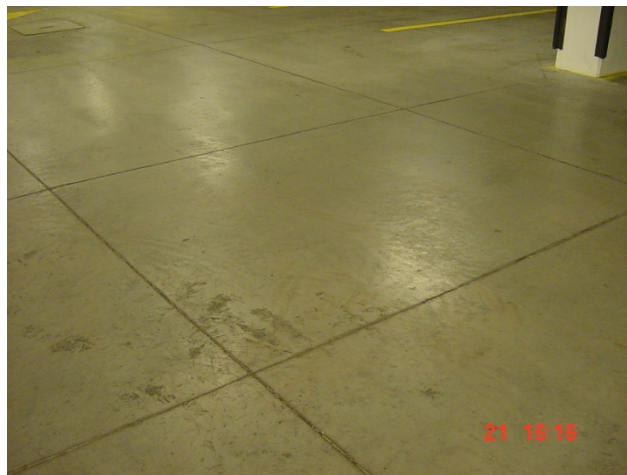
Ilustración 7.14: Parqueadero de Supercines con fibra RXF54, trazado de las juntas Fuente: Miguel Rivera y José Sosa
