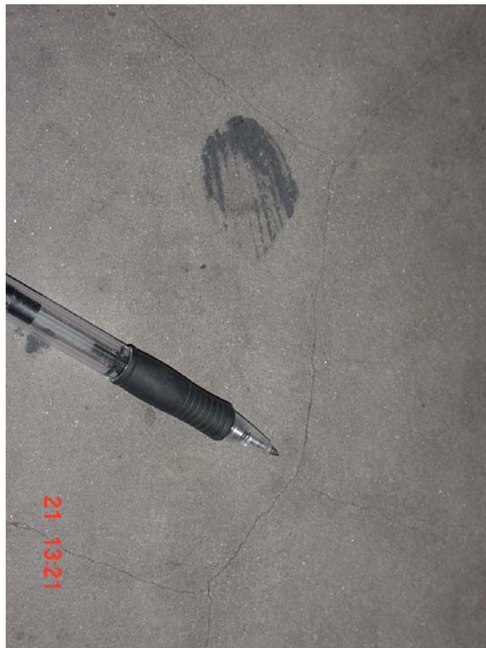
Ilustración 7.9: Parqueadero del Condado Shopping con fibra RXF54, identificación de pequeñas fisuras
