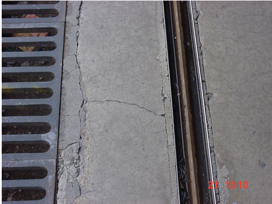
Ilustración 7.11: Daños en las esquinas de elementos del parqueadero Fuente: Miguel Rivera y José Sosa
