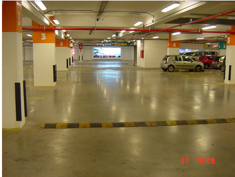
Ilustración 7.13: Parqueadero de Supercines con fibra RXF54, losas en perfectas condiciones Fuente: Miguel Rivera y José Sosa
