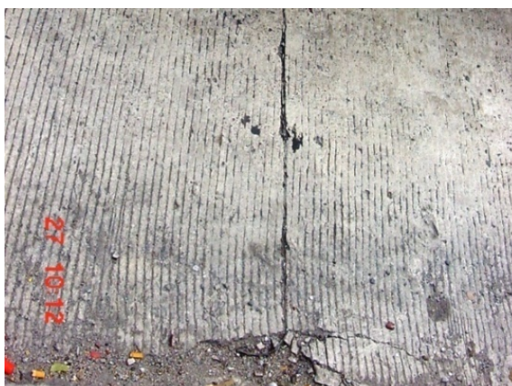
Ilustración 6.16: Daños producidos en las esquinas de las juntas Fuente: Miguel Rivera y José Sosa
