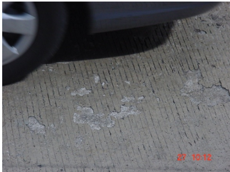
Ilustración 6.15: Desgaste normal de la superficie del pavimento rígido Fuente: Miguel Rivera y José Sosa
