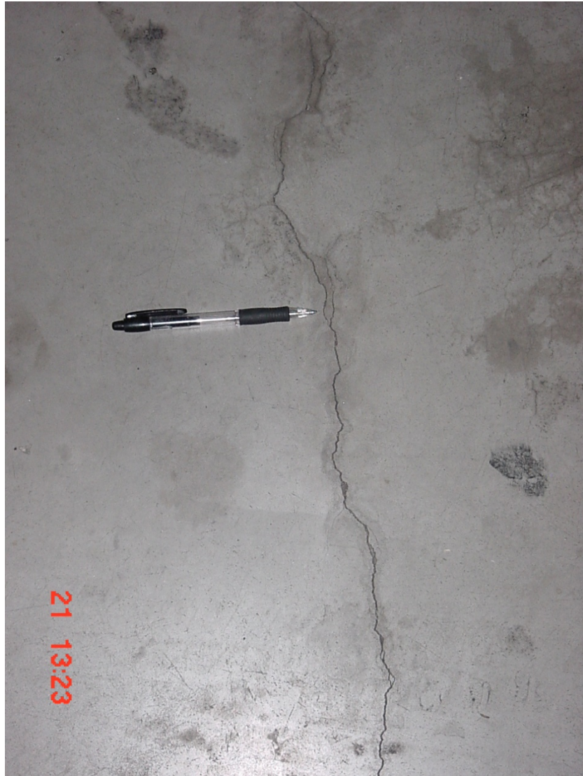
Ilustración 7.10: Parqueadero del Condado Shopping sin fibra RXF54, identificación de fisuras de gran longitud Fuente: Miguel Rivera y José Sosa
