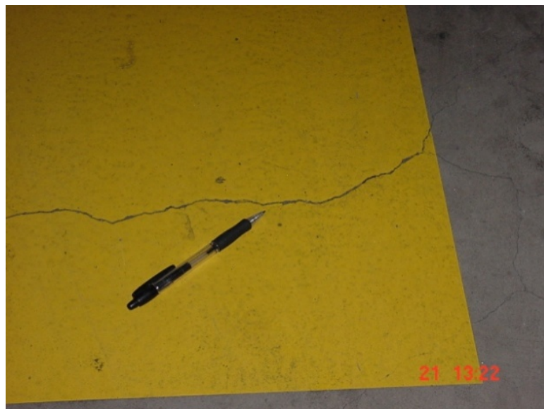
Ilustración 6.5: Fisuras en los parqueaderos Fuente: Miguel Rivera y José Sosa
