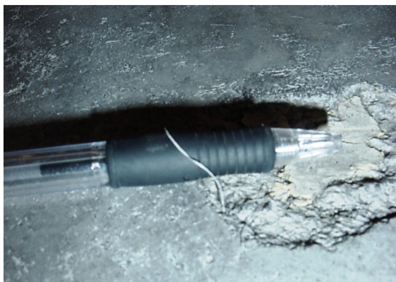
Ilustración 6.12: Identificación de un bache donde se puede apreciar a la fibra RXF54 Fuente: Miguel Rivera y José Sosa
