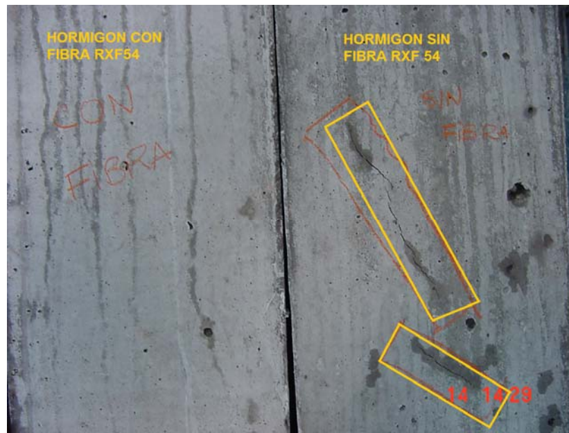
Ilustración 7.3: Fisuramiento por retracción plástica en las superficies de las viguetas con y sin fibra Fuente: Miguel Rivera y José Sosa
