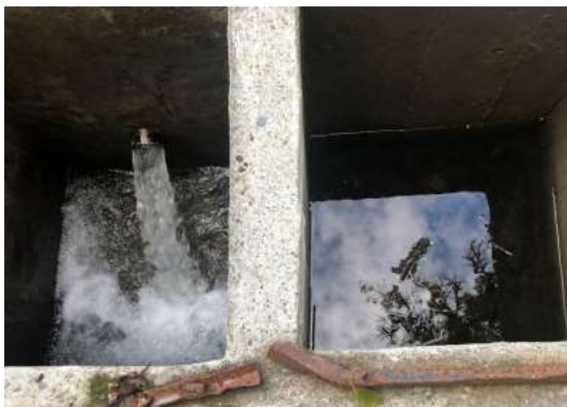
Figura 29. Caja de Válvulas
