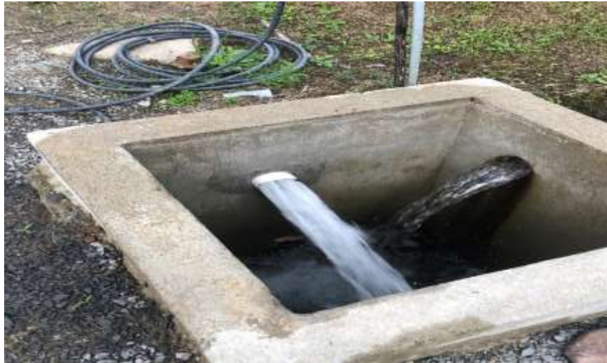
Figura 44. Cámara de Excesos
