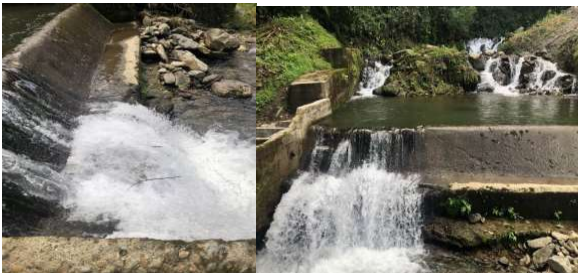
Figura 25. Erosión y Socavación en el Azud
