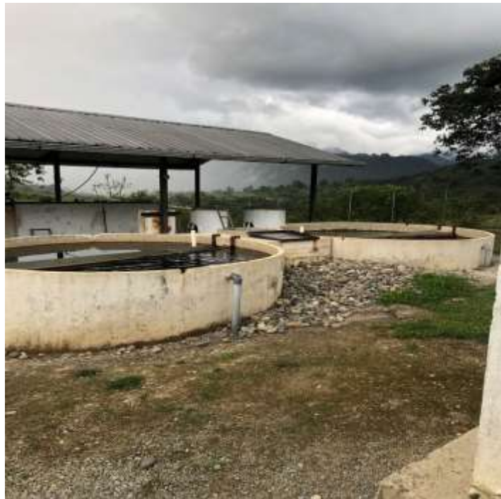
Figura 18. Filtros de Arena Rápidos
