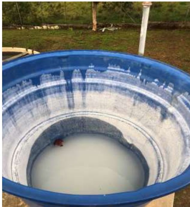
Figura 19. Tanque de Cloración
