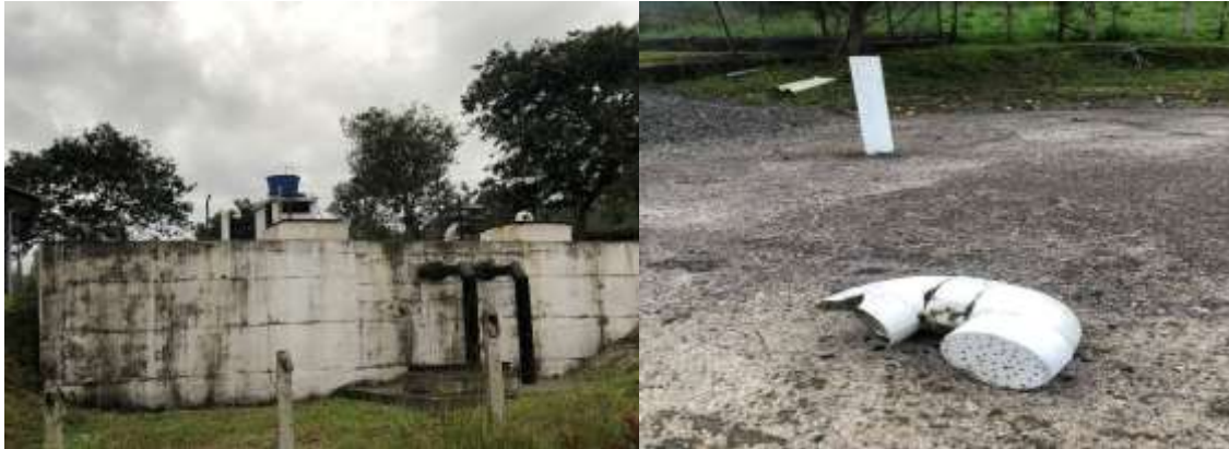
Figura 20. Tanque de Reserva
