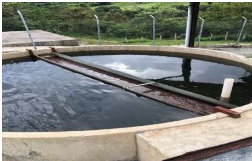
Figura 42. Filtros Rápidos de Arena Colmatados
