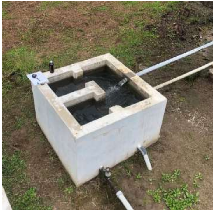
Figura 40. Repartidor de Caudales
