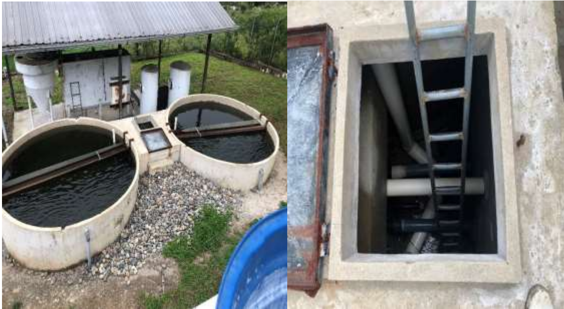
Figura 41. Filtros Rápidos de Arena: Vista Externa e Interna
