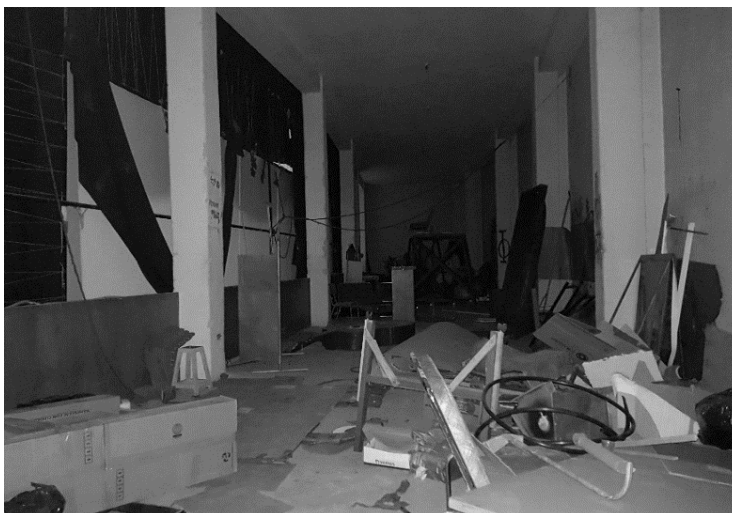
Figura 2. Estado actual de la instalación en la zona detrás del escenario.
