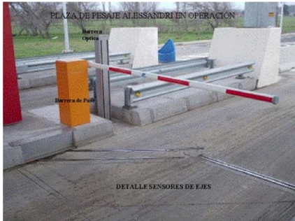
Detalle de barrera mecánica y sensores de piso
