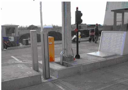
Detalle de la barrera óptica para separación de vehículos
