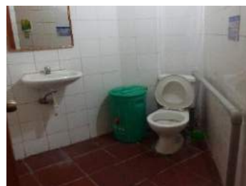
Baterías sanitarias para PCD
