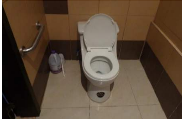
Batería sanitaria en el primer piso
