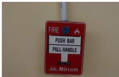
Alarma de incendios
