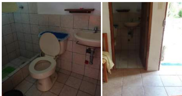
Batería sanitaria en la Quinta la Posada
