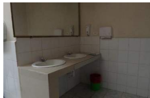
Lavamanos de las baterías sanitarias
