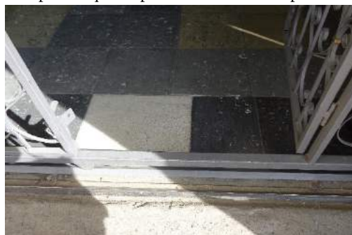
Desnivel de ingreso a la iglesia
