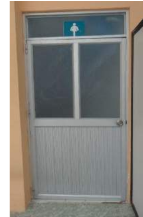
Puerta de batería sanitaria
