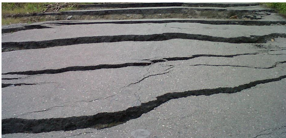
Ilustración 30 Falla en Carpeta Asfáltica Producida por Suelos Expansivos
