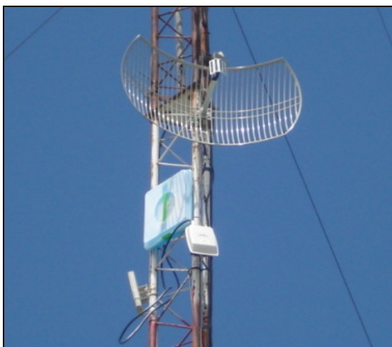
Figura 4.22. Equipos instalados en la torre [48]
