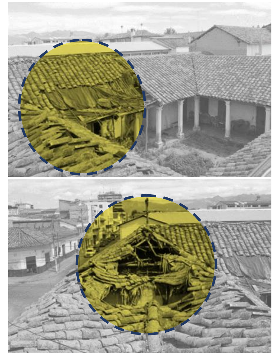
Figura. 70 Fotografías del estado actual de la cubierta de la casa madre.
