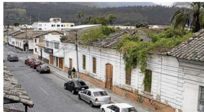
Figura. 3 Fotografía del estado actual de deterioro de una edificación
