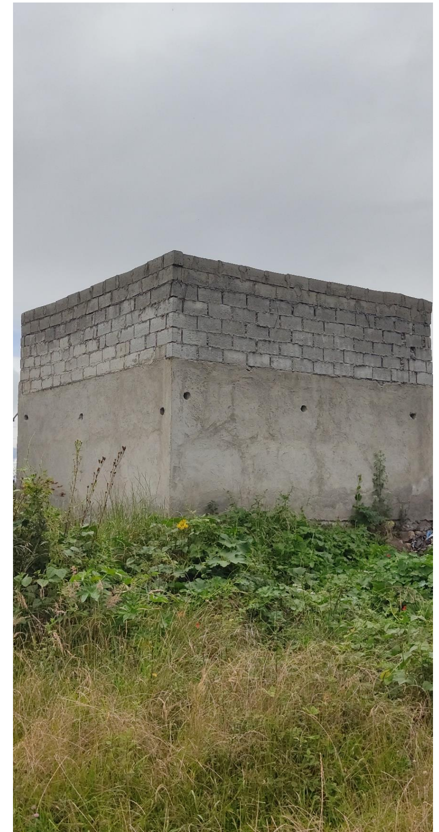
Imagen 174: Caja repartidora de agua de regadío “El Óvalo” rodeado de maleza y escombros
