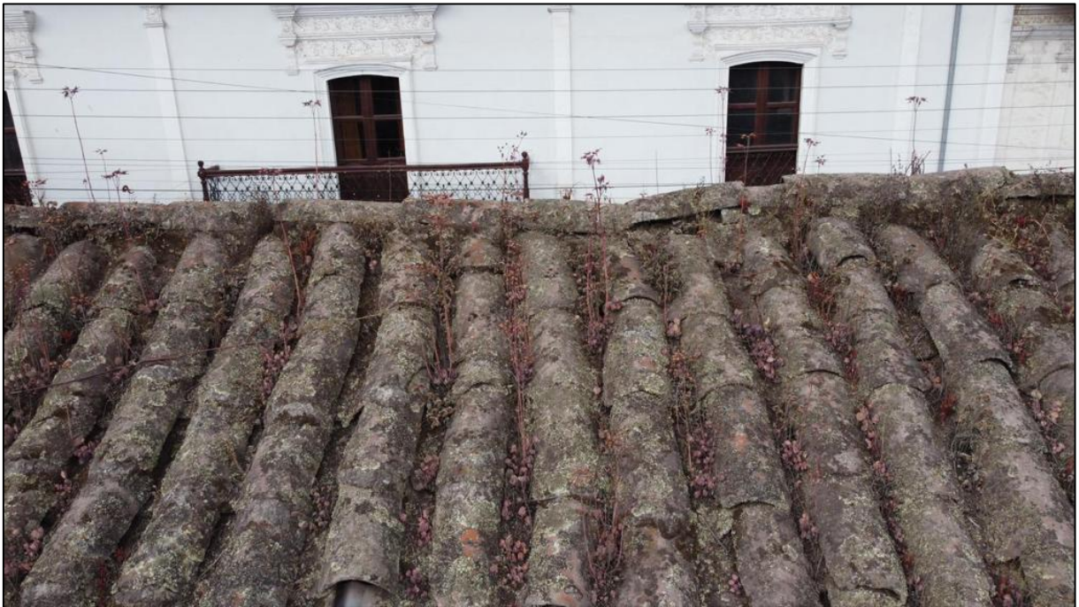
Ilustración 45: Vegetación en tejas de cubiertas – Elaboración Propia
