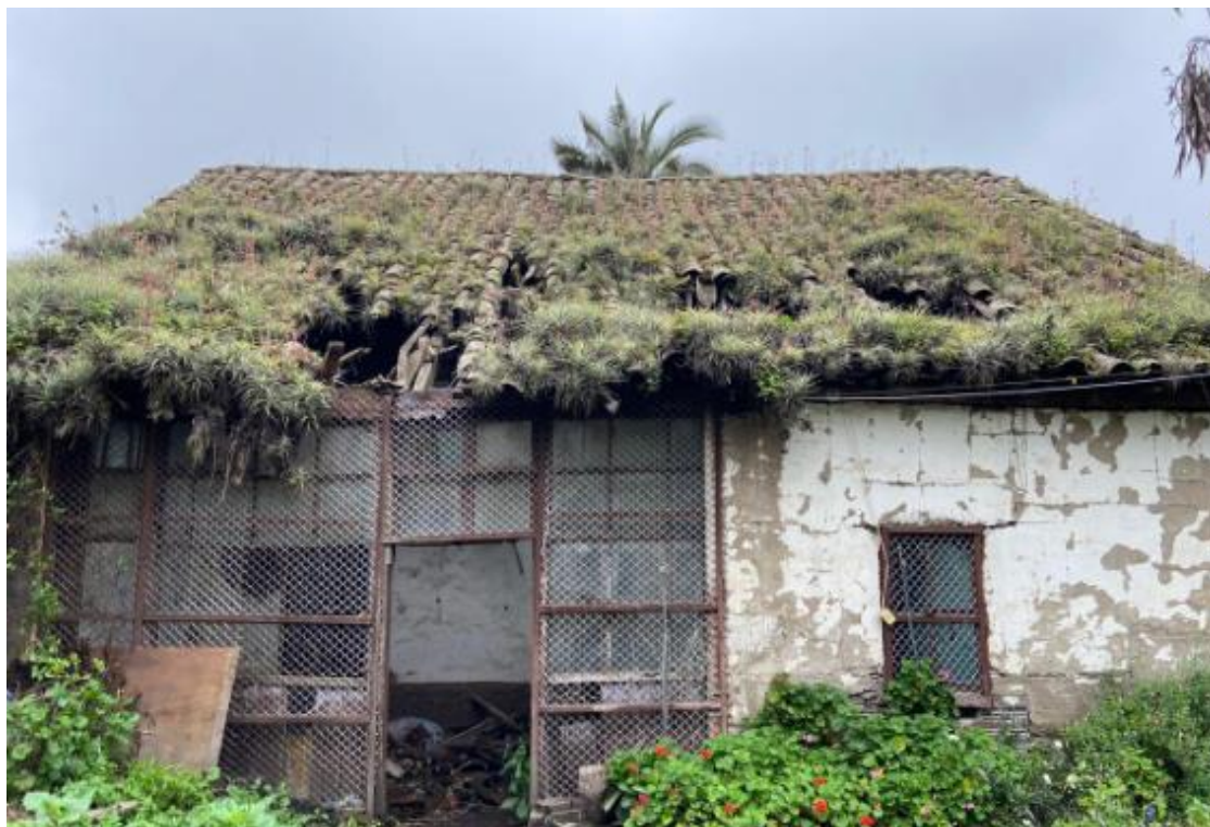
Ilustración 46: Vegetación de tejas en cubiertas - Elaboración Propia
