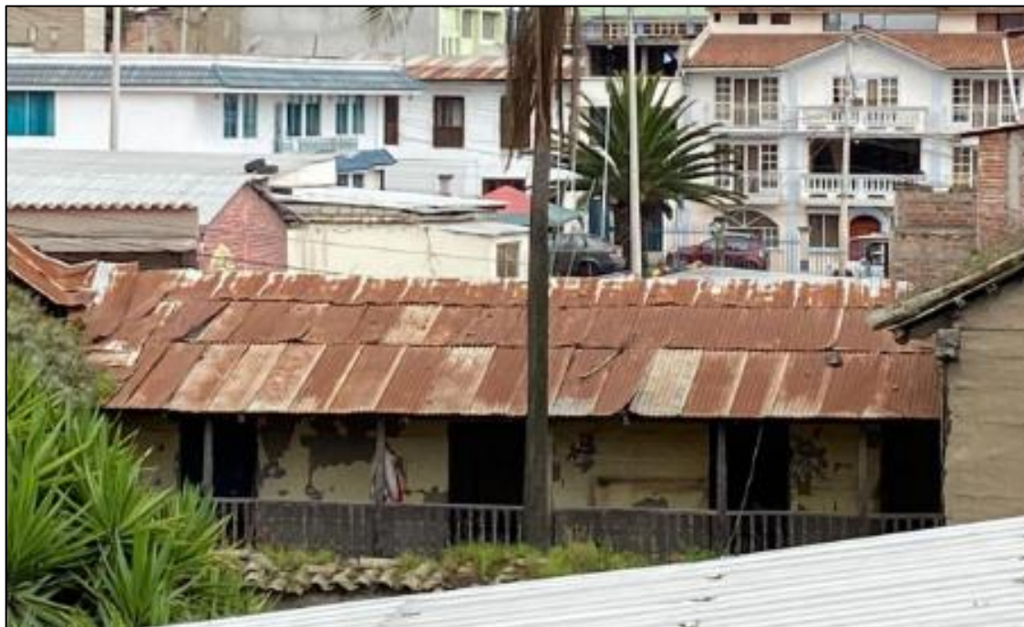
Ilustración 48. Rotura en la hoja de Zinc – Elaboración Propia
