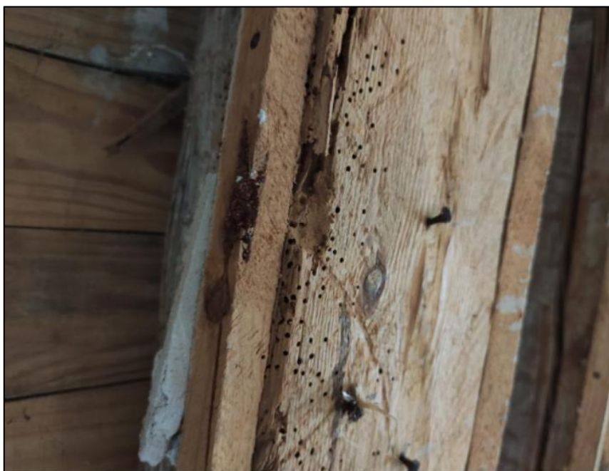
Ilustración 38 Madera afectada por xilófagos - (Parra & Olivera)
