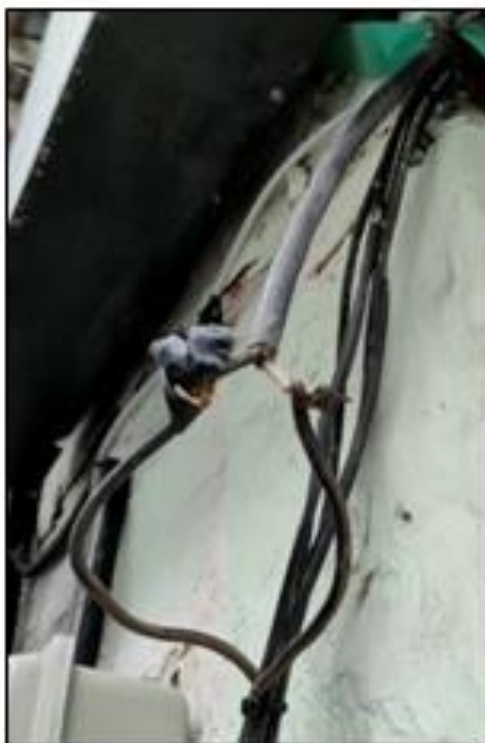
Ilustración 54: Alambre mal empalmado - Elaboración Propia
