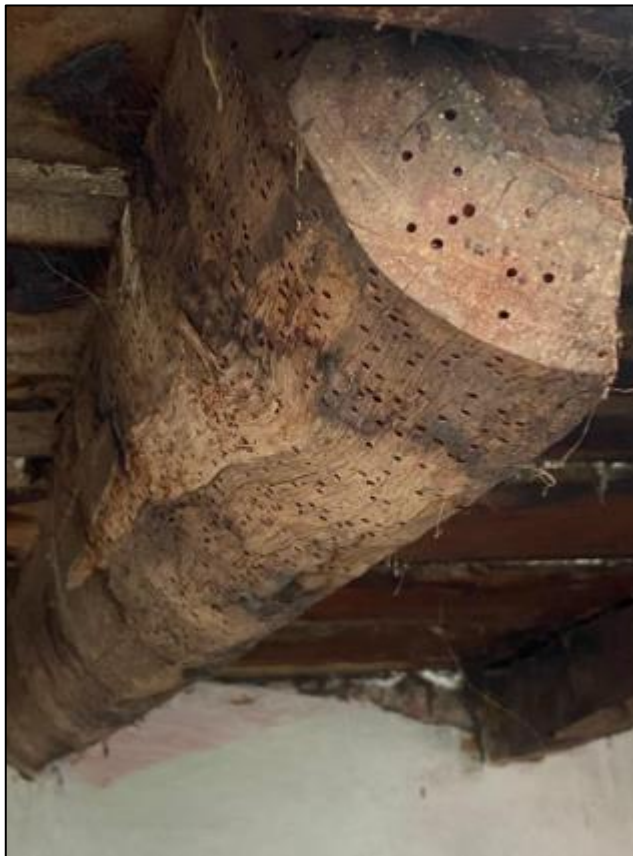
Ilustración 16: Madera con termitas - Elaboración Propia
