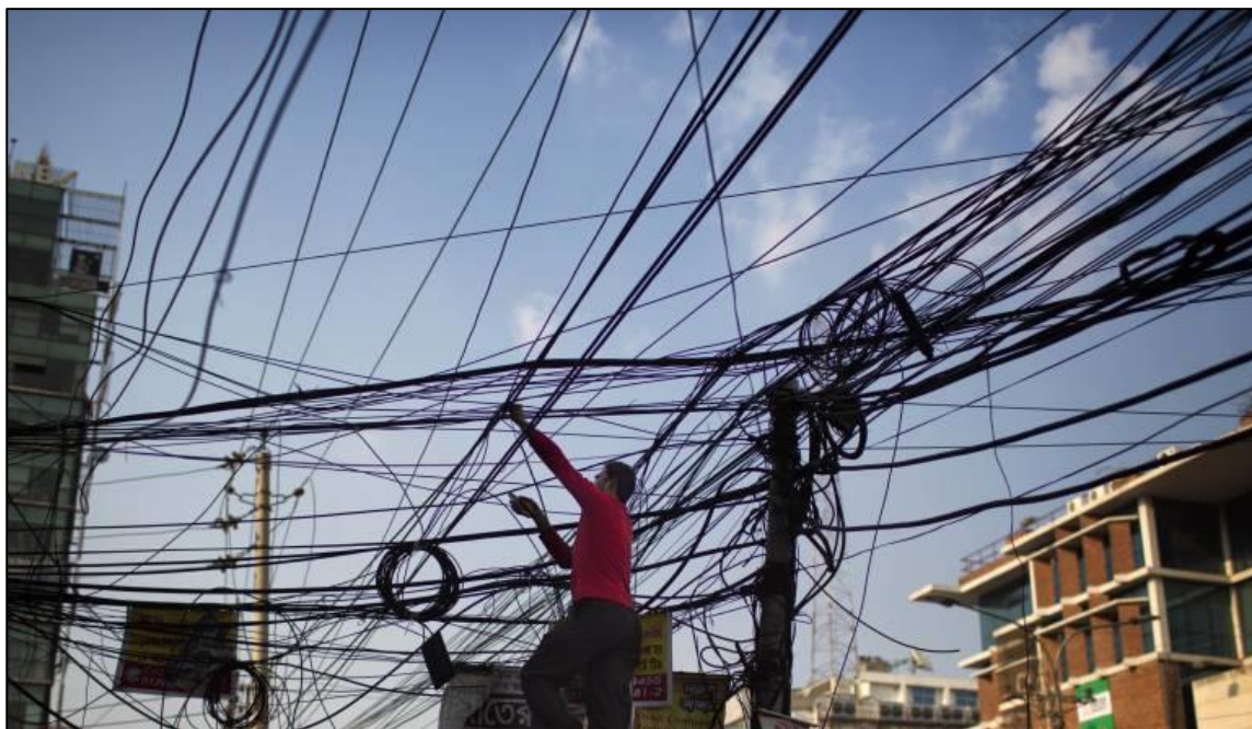
Ilustración 52 Cableado eléctrico en mal estado fuera de las viviendas. - (Bolgger, 2018)
