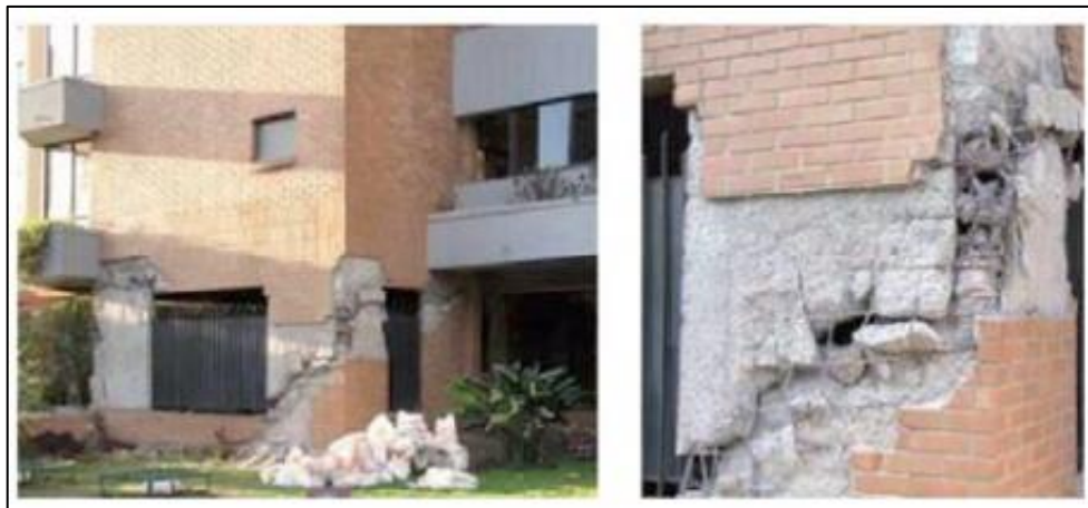
Ilustración 23: Falla por cortante en muros - (San Bartolomé, Quiun, & Silva , 2011)
