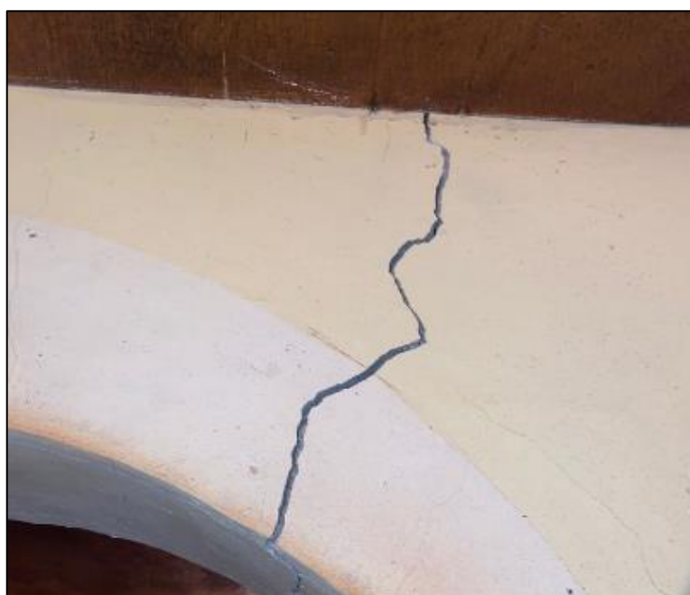
Ilustración 17: Fisura en muro - Elaboración Propia
