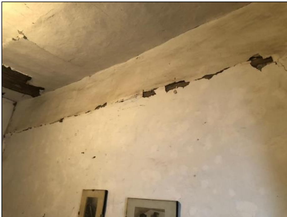
Ilustración 19: Deformación del muro - Elaboración Propia
