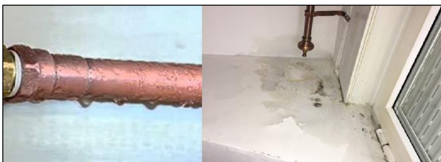
Ilustración 59: Humedad debido a instalaciones sanitarias - Fuente: Google imágenes
