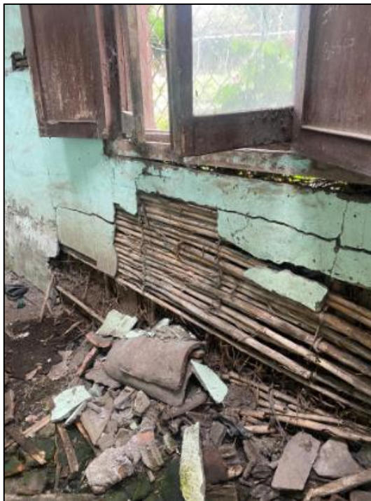
Ilustración 30: Desprendimiento del enlucido - Elaboración Propia
