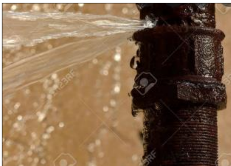
Ilustración 62: Rotura en tuberías – Albaladejo, 2019.
