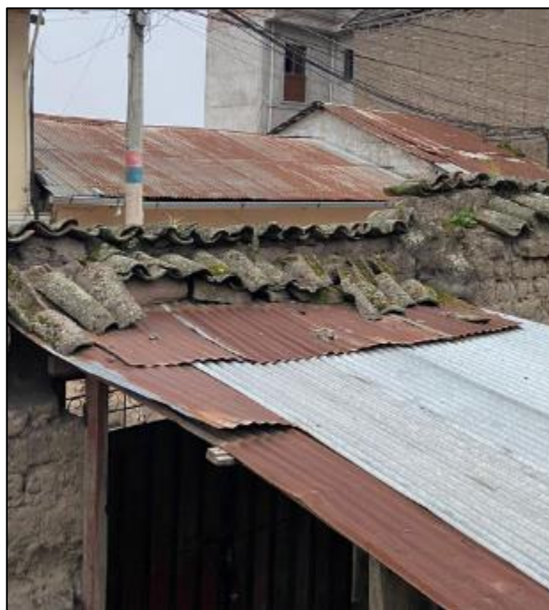
Ilustración 47: Corrosión del Zinc - Elaboración Propia
