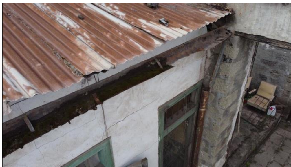
Ilustración 42: Daños en aleros y bajantes - Elaboración Propia
