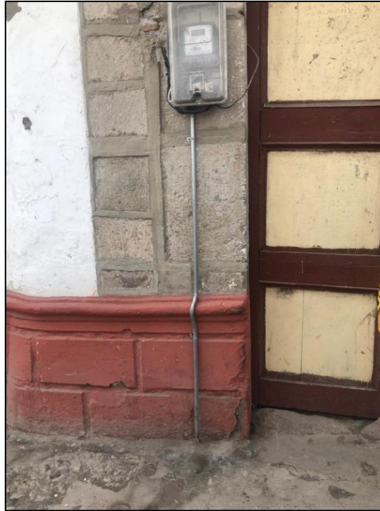
Ilustración 50: Falta de conexión a tierra - Elaboración Propia
