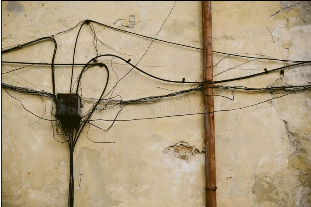
Ilustración 55 Caja general de protección deteriorada. - (Trofymiuk, s.f.)
