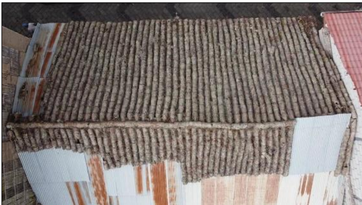
Ilustración 43: Rotura o Caída de tejas - Elaboración Propia
