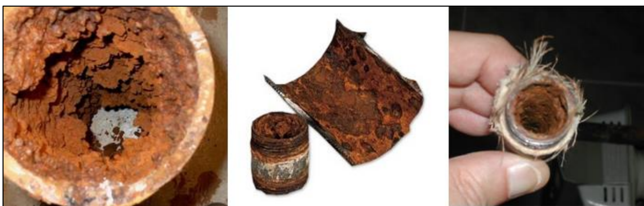
Ilustración 60: Tuberías corroídas - Fuente: Google Imágenes
