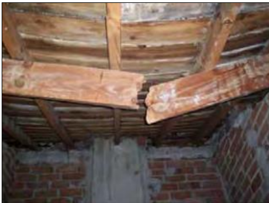
Ilustración 35 Rotura de correas y vigas. - (Lasheras Merino & García Casas)
