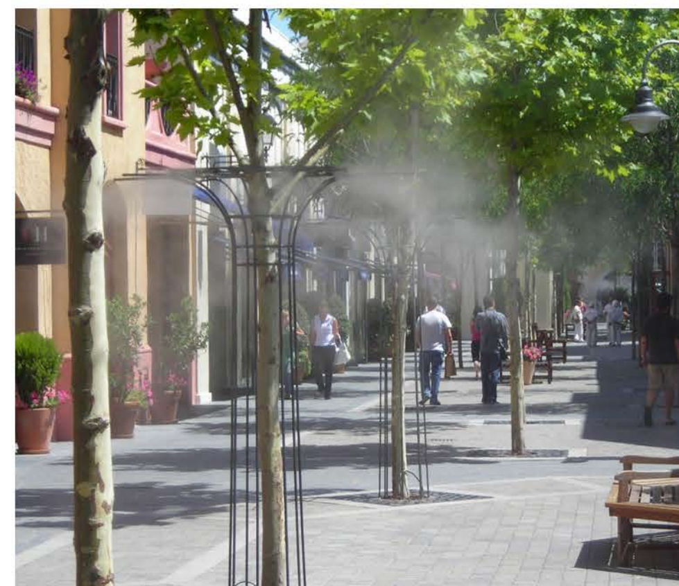
Climatización de las plazas mediante aspersores.
