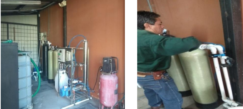
Figura 11. Unidades de la PTAR de los laboratorios de la ECAA.
