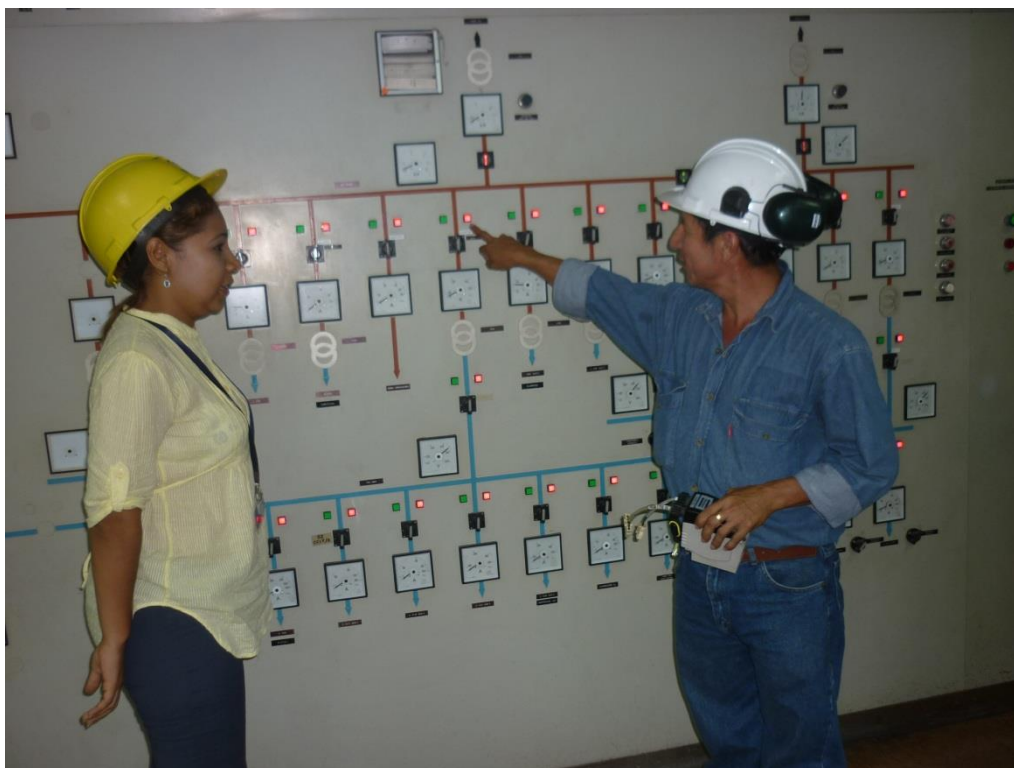
Foto Nro. 4: Control de Sala de Mando
