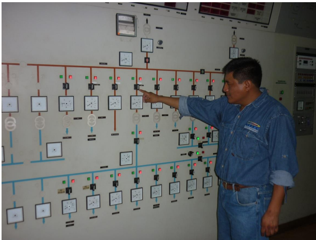
Foto Nro. 3: Control de Sala de Mando
