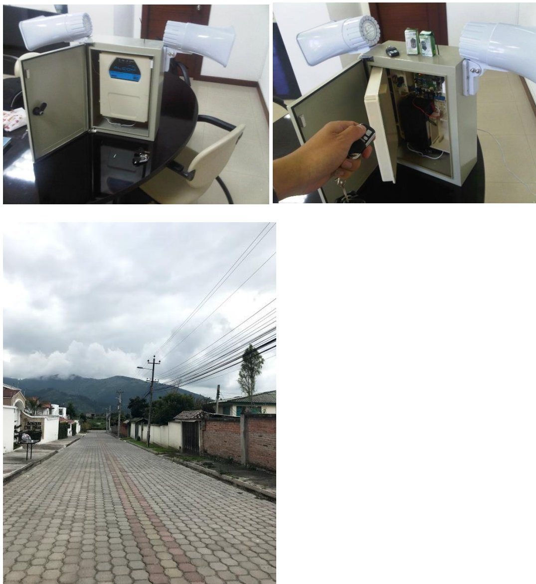
Figura 43. Alarma Comunitaria con pulsadores y distancia 100mts línea de vista.
