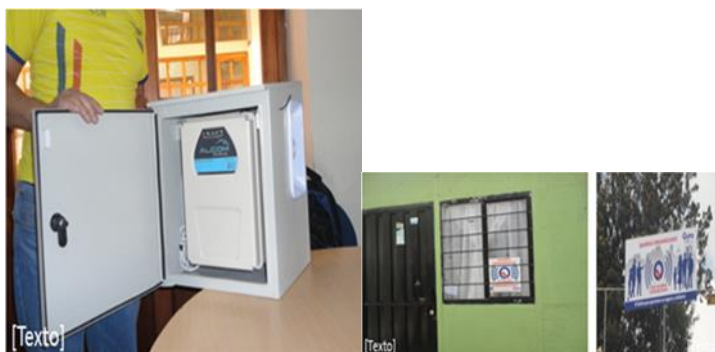
Figura 6. Alarmas Comunitarias Alcom EM Seguridad. (Empresa Metropolitana de Seguridad, 2012)
