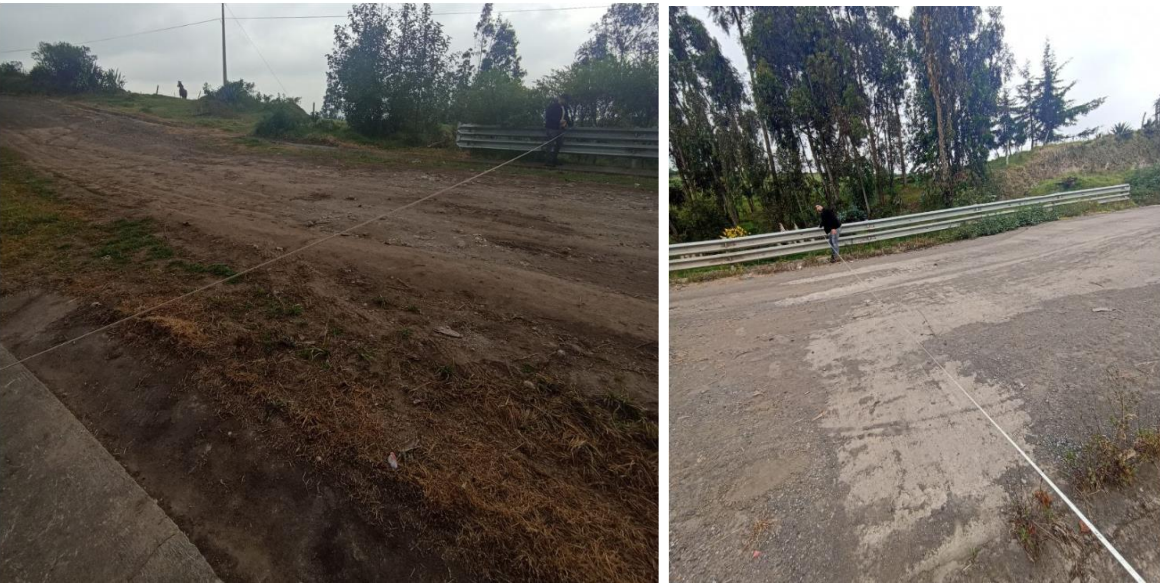
19. Evaluación de estado, definición de superficie de rodadura y anchos de vía
