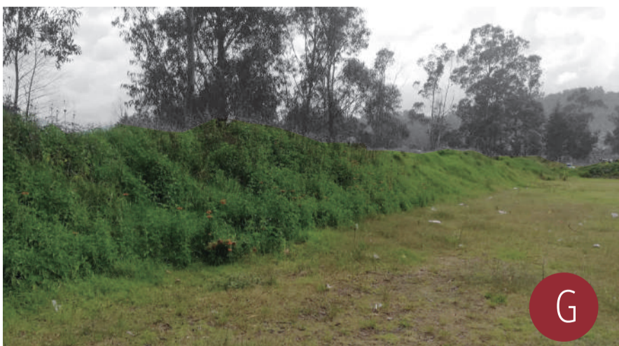
G Talúd de contención artesanal en borde de quebrada.
