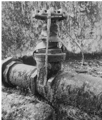
Imagen 43. Tubería de acero
