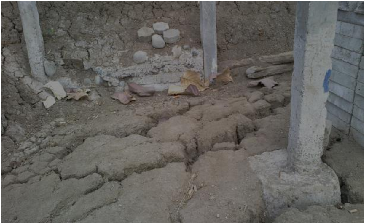
Figura 1.3: Levantamiento de estructuras causado por la acción de suelos expansivos, sector Calcical.
