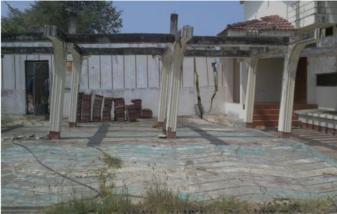
Figura 1.4: Daños Generados por la acción de suelos expansivos en el sector Calcical
