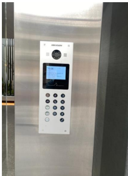
Figura 10. Control de acceso del Edificio BÔ
