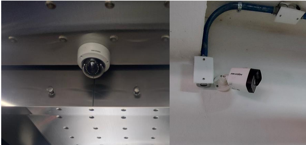
Figura 9. Sistema de seguridad del Edificio BÔ
