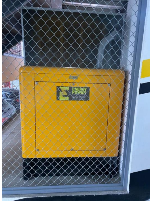
Figura 8. Generador trifásico del Edificio BÔ
