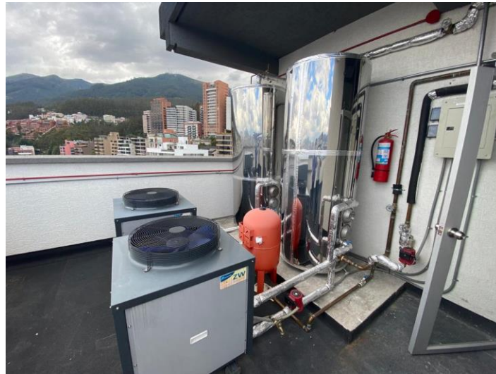
Figura 11. Sistema centralizado de calentamiento de agua del Edificio BÔ
