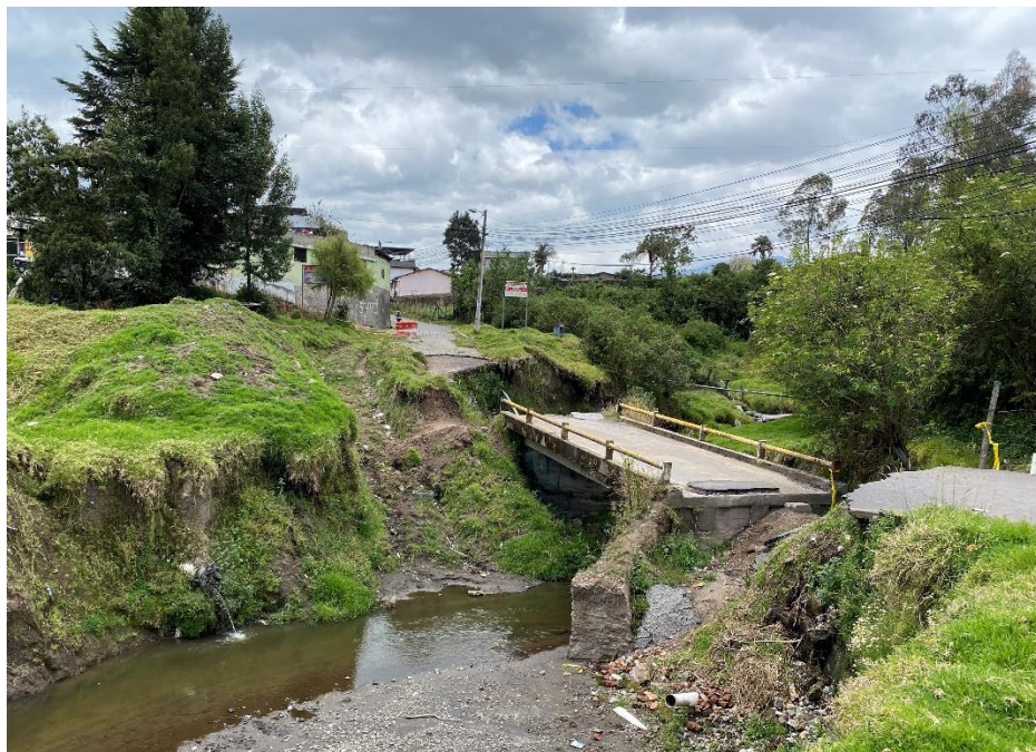
Ilustración 30: Colapso de infraestructura de puente por socavación en estribos. (Fuente propia)
