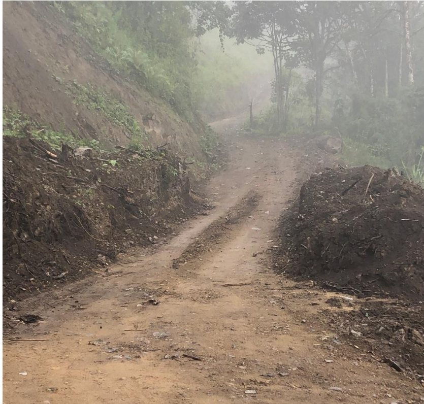
Ilustración 31: Derrumbe sobre la carretera. (Fuente propia)
