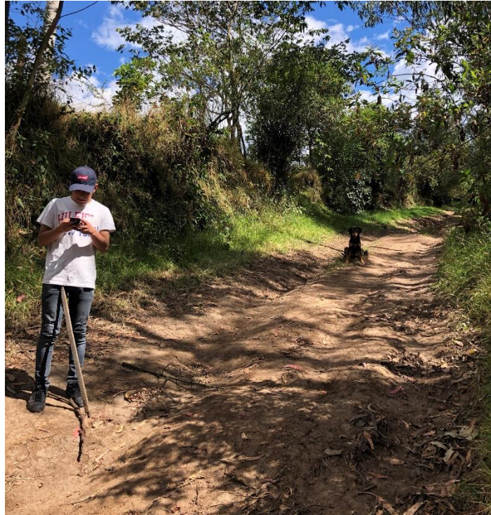
Ilustración 33: Tramo vial deteriorado con presencia de vegetación y árboles que cubrían la superficie de rodadura. (Fuente propia)
