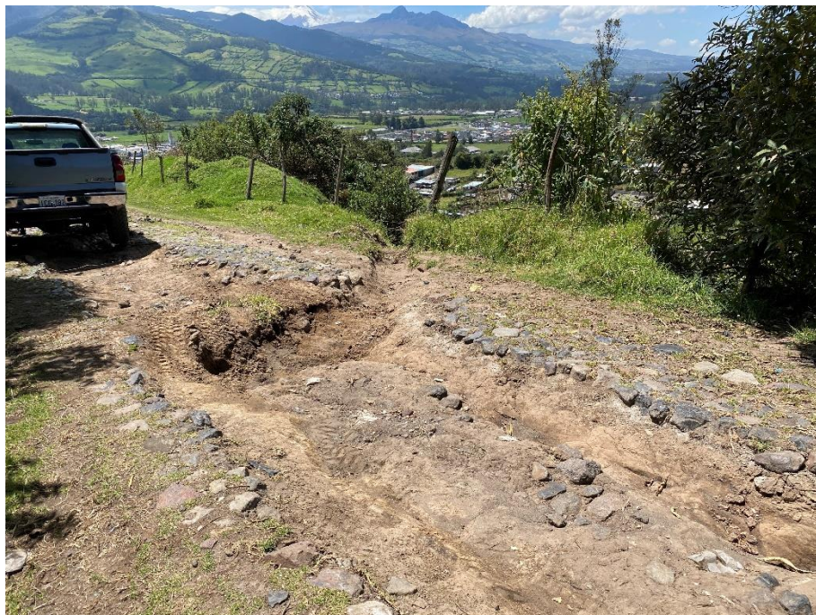
Ilustración 27: Vía con desprendimiento de superficie de rodadura (Fuente propia)
