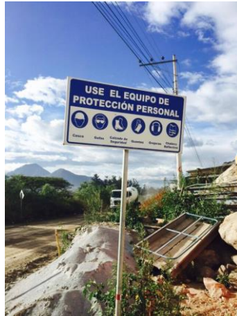
Fotografía 16: Señal de obligatoriedad de protección a la entrada del talud 7+500
