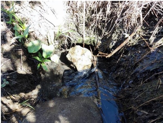
Circular de hormigón en mal estado
