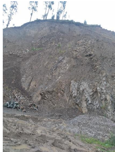
Talud intervenido inestable
