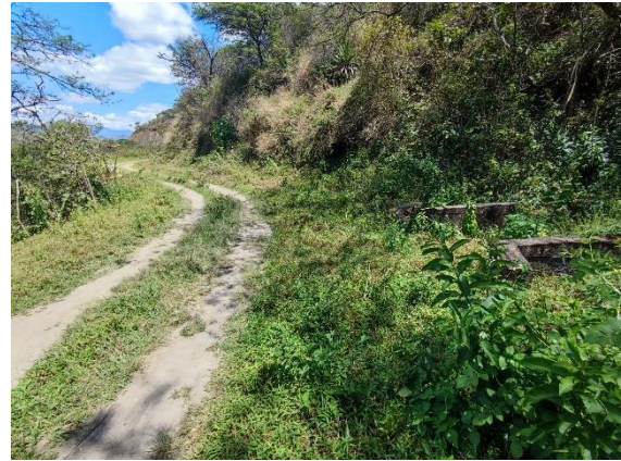
Badén en mal estado
