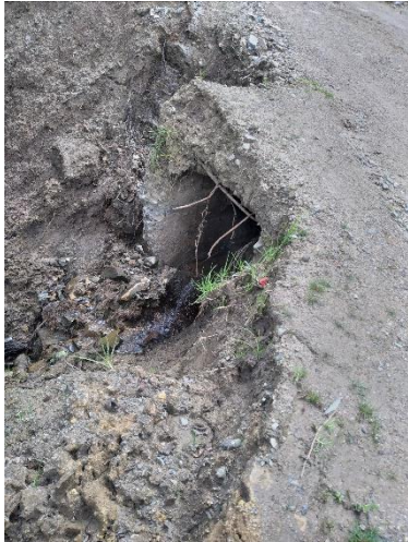
Cajón de hormigón en mal estado
