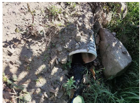
Circular de PVC en buen estado
