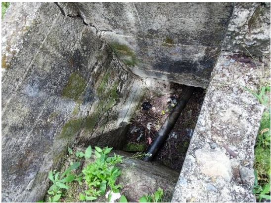
Cabezal tipo cajón en mal estado
