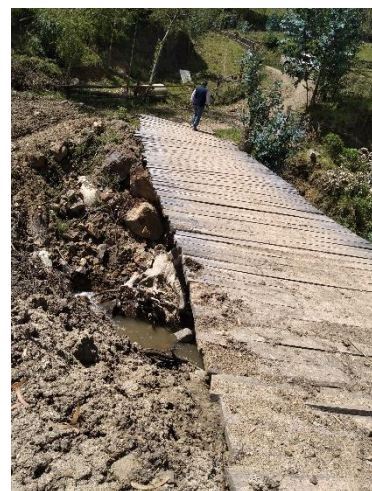
Superestructura del puente de madera en mal estado
