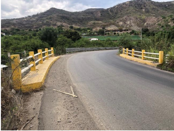
Pavimento flexible bueno
