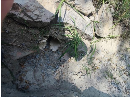
Circular de PVC en mal estado
