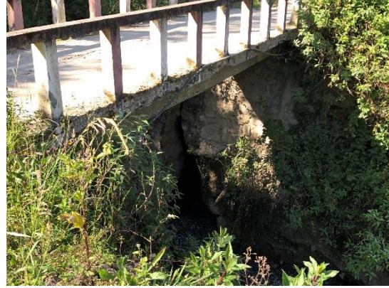
Infraestructura del puente en mal estado
