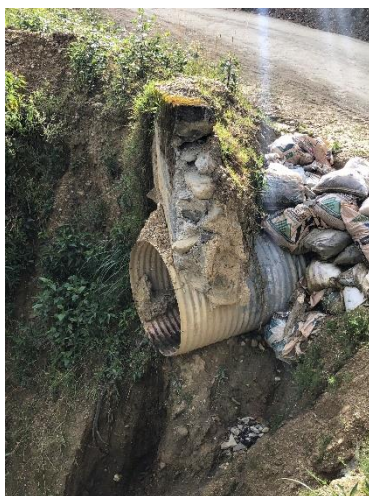
Cabezal tipo aletas en mal estado
