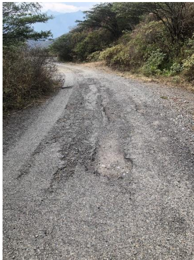
Pavimento flexible malo
