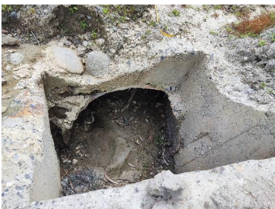
Circular metálica en mal estado
