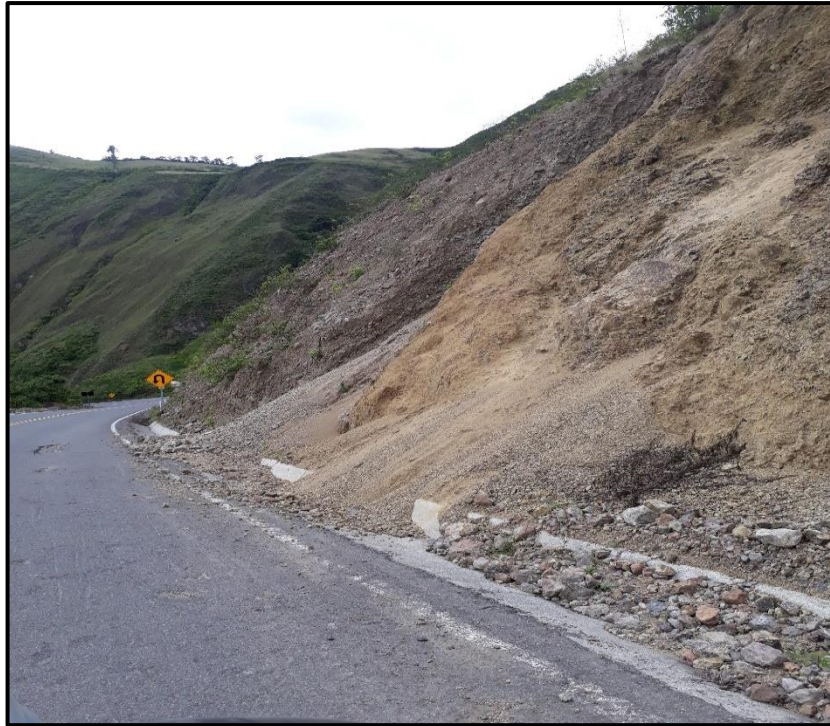
Figura. 40. Deslizamiento #41 Vía Juan Montalvo
