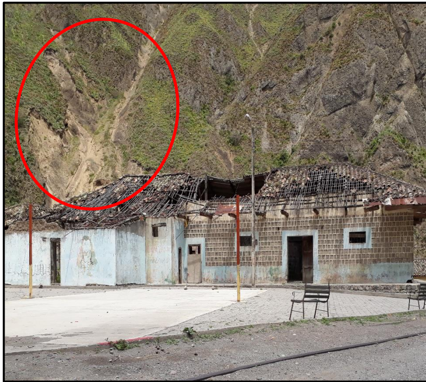
Figura 41. Deslizamiento #72 en el Sector de Estación Carchi
