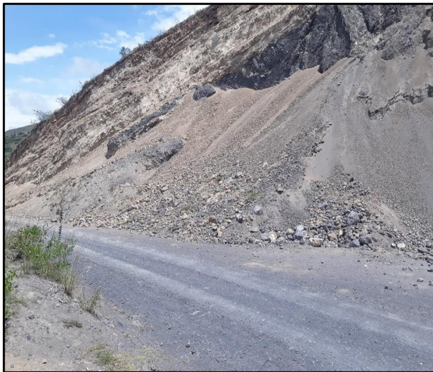
Figura 43. Deslizamiento #86 en la Vía Santa Lucia
