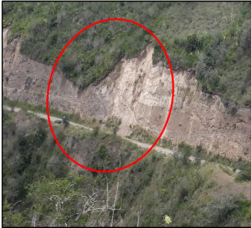
Figura 42. Deslizamiento #80 en la Vía el Rosal
