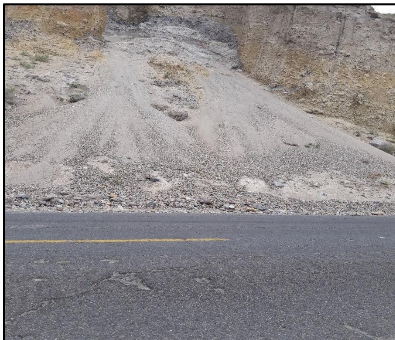
Figura 37. Deslizamiento #7 en el desvío Playa Rica
