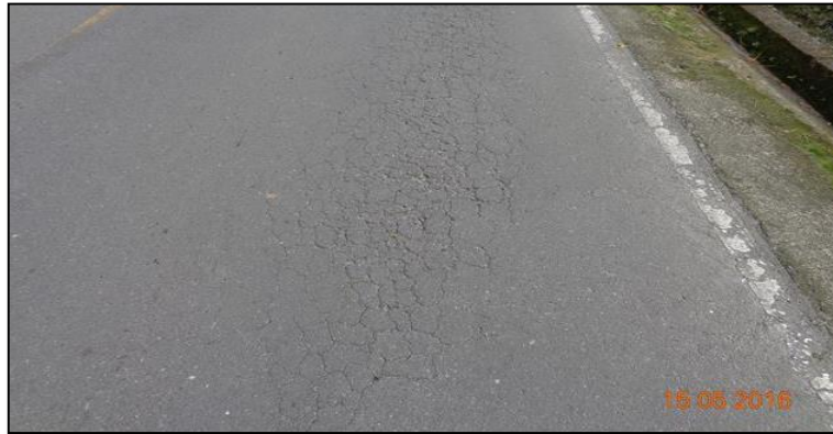
Ilustración 3-1 Falla Piel de Cocodrilo
