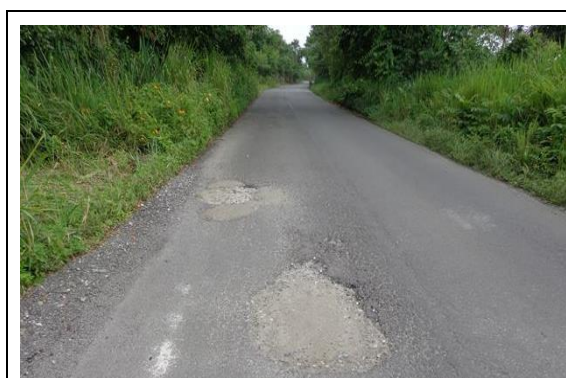
Ilustración 3-11. No existen cunetas lado izquierdo y derecho ,Abscisa 5+750-7+500
