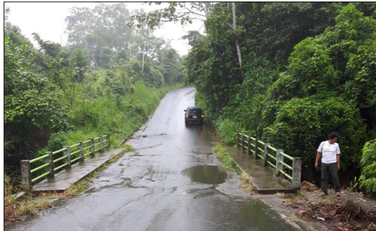
Ilustración 3-6. Falla Acceso a Puentes
