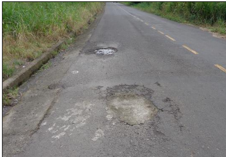
Ilustración 3-4. Falla Parches / Corte servicio
