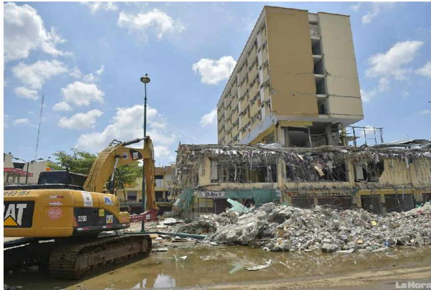
Figura 38. Centro comercial destruido por el terremoto
