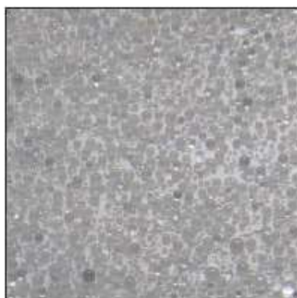
Figura 3-10 Nivel de penetración insuficiente. (Frédéric Boily, 2014)
