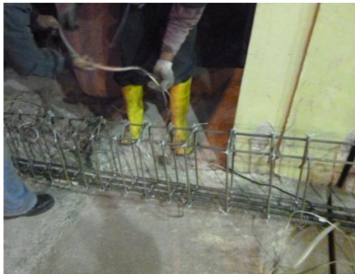
Foto 53 Manguera de protección de strain gage
