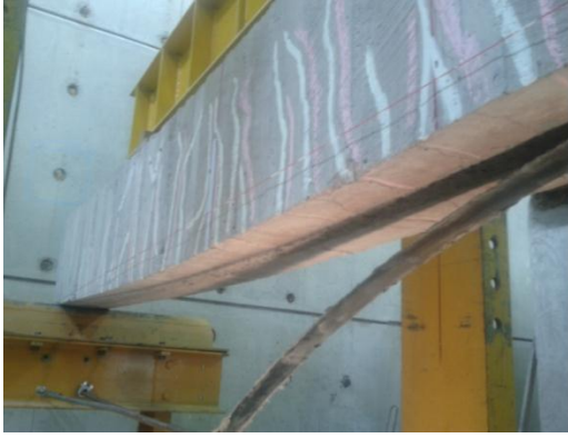
Foto 74 Estado de fisuras y fibra desprendida
