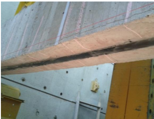
Foto 64 Control de fibra de carbono
