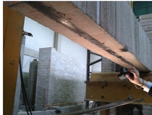
Foto 61 Control de fibra de carbono
