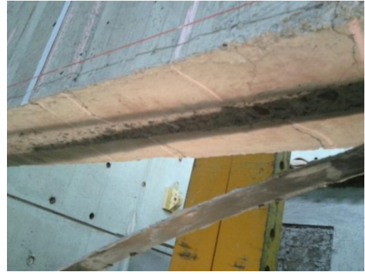
Foto 67 Desprendimiento de fibra de carbono
