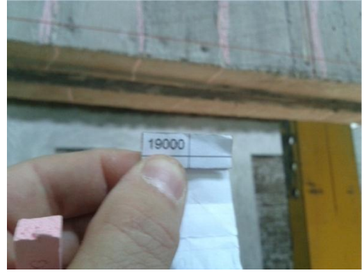
Foto 66 Control de fibra de carbono
