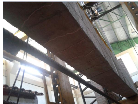
Foto 32 Grietas en fondo de viga
