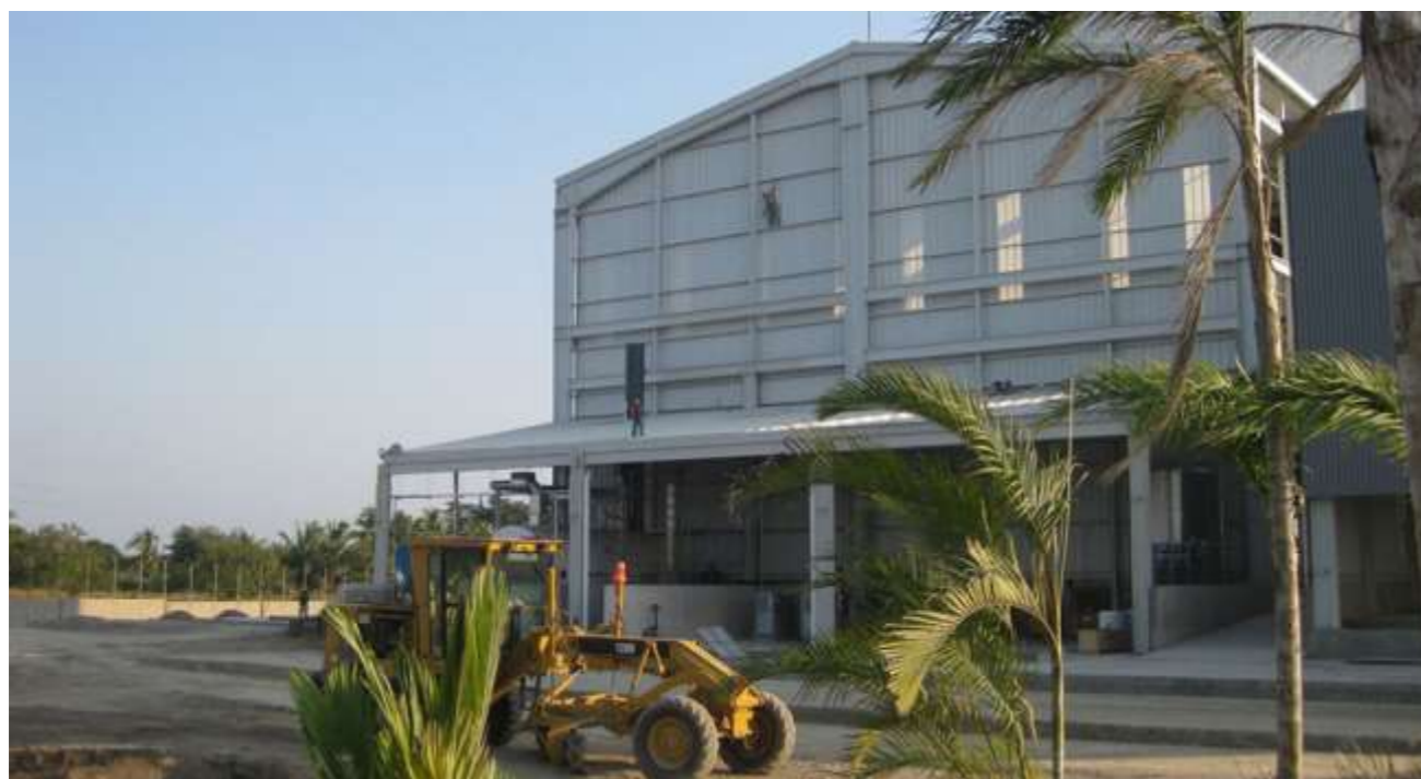
Figura 11 Vista exterior Planta liofilizadora de café Fuente: (BAQ, 2016)
