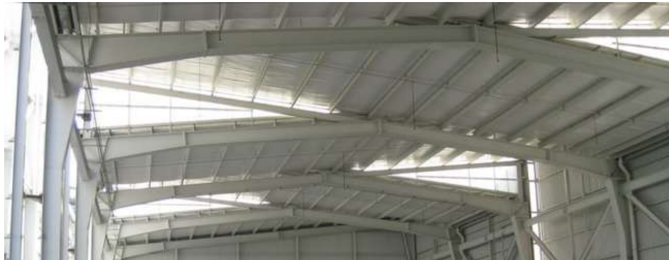
Figura 26 Vista de la Estructura interior Planta liofilizadora de Café Fuente: (BAQ, 2016)
