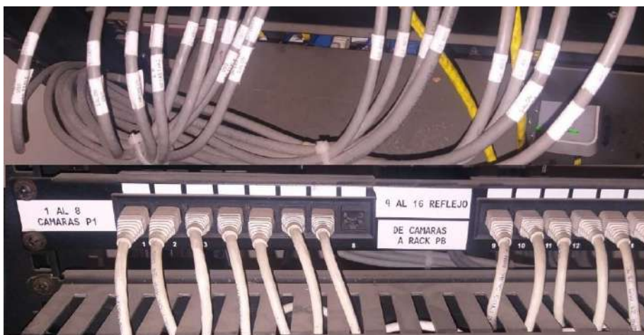
Figura 68: Etiquetado de identificación del cableado
