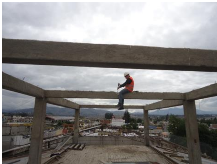
Figura 30: Técnica de corte de vigas. Fuente: foto tomada el 23 de noviembre de 2016 (Cabezas, I.)
