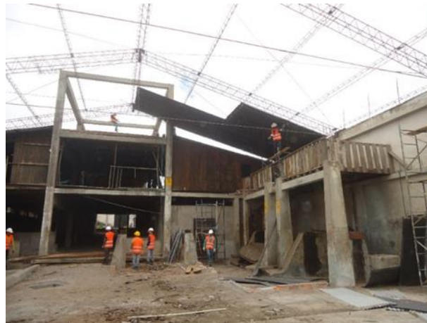
Figura 35: Desmontaje manual de elementos de cubierta según el método de arriba hacia abajo. Fuente: foto tomada el 23 de noviembre de 2016 (Cabezas, I.)
