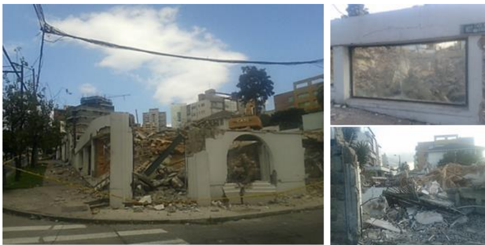
Figura 12: Derrocamiento en Av. Orellana y San Javier: retroexcavadora en acción, ninguna recuperación de materiales, mezcla de elementos de hierro, madera, concreto, etc. Fuente: fotos tomada el 4 de abril de 2017 (Cabezas I., 2017)
