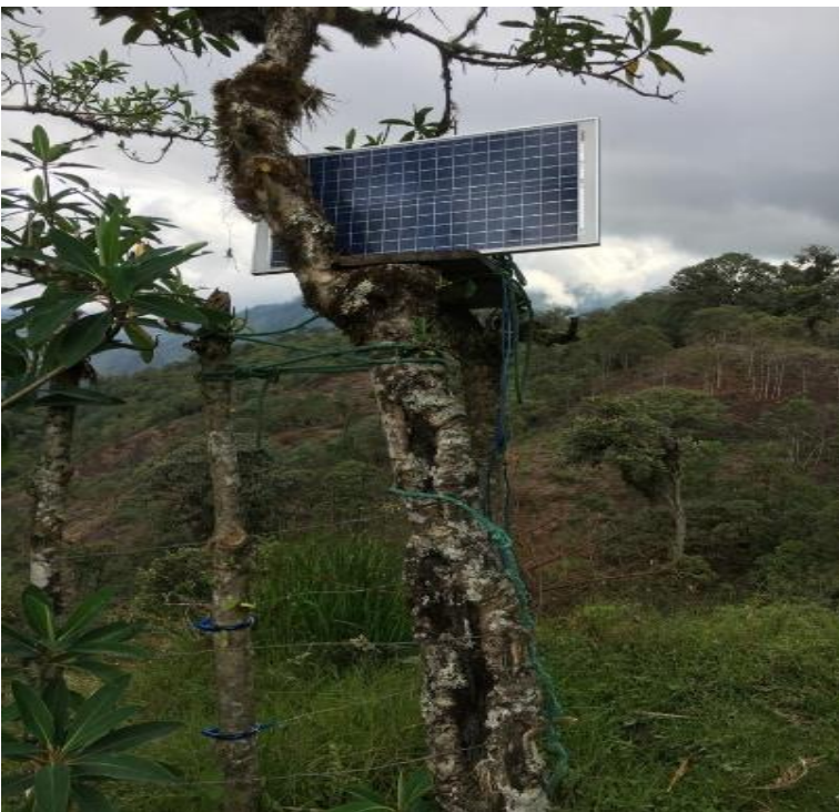
Figura 32. Cerca eléctrica con paneles solares y varilla de cobre
