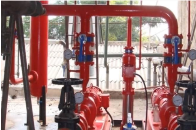
Figura. 6. Bombas contra incendios
