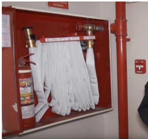
Figura. 8. Gabinete Contra Incendios Equipado
