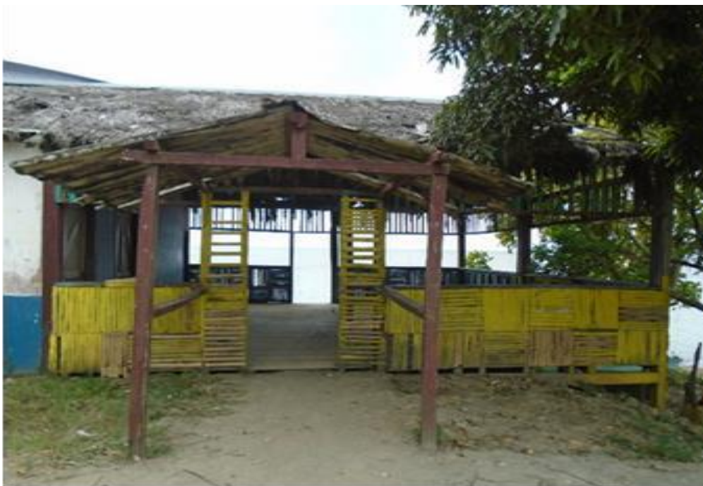
Emprendimiento Restaurante en deterioro.
