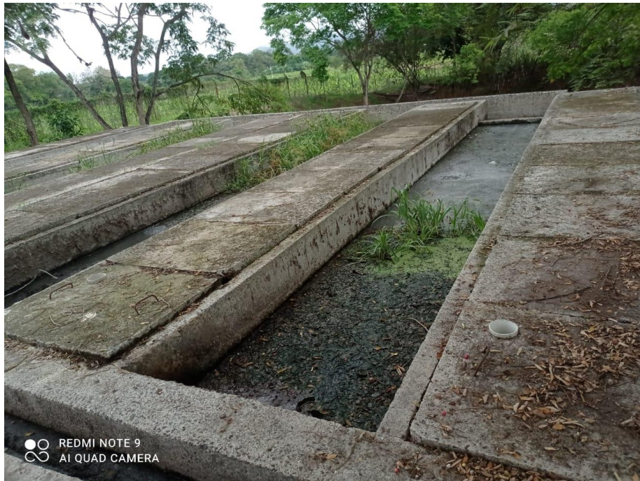
Foto 3. Estructura del tanque Imhoff
